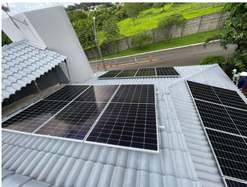
Figura 29 - Sistema Solar Residencial formado por 15 placas de 560 Wp.
