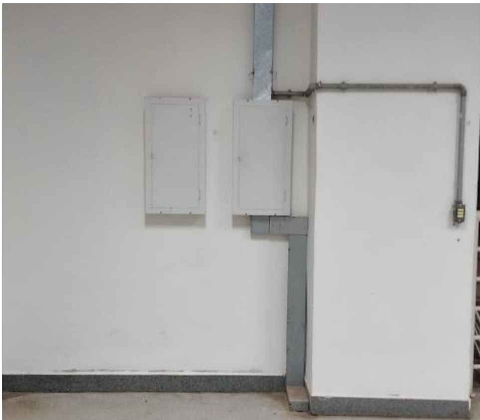
Figura 4.3: Quadro de distribuição reserva
