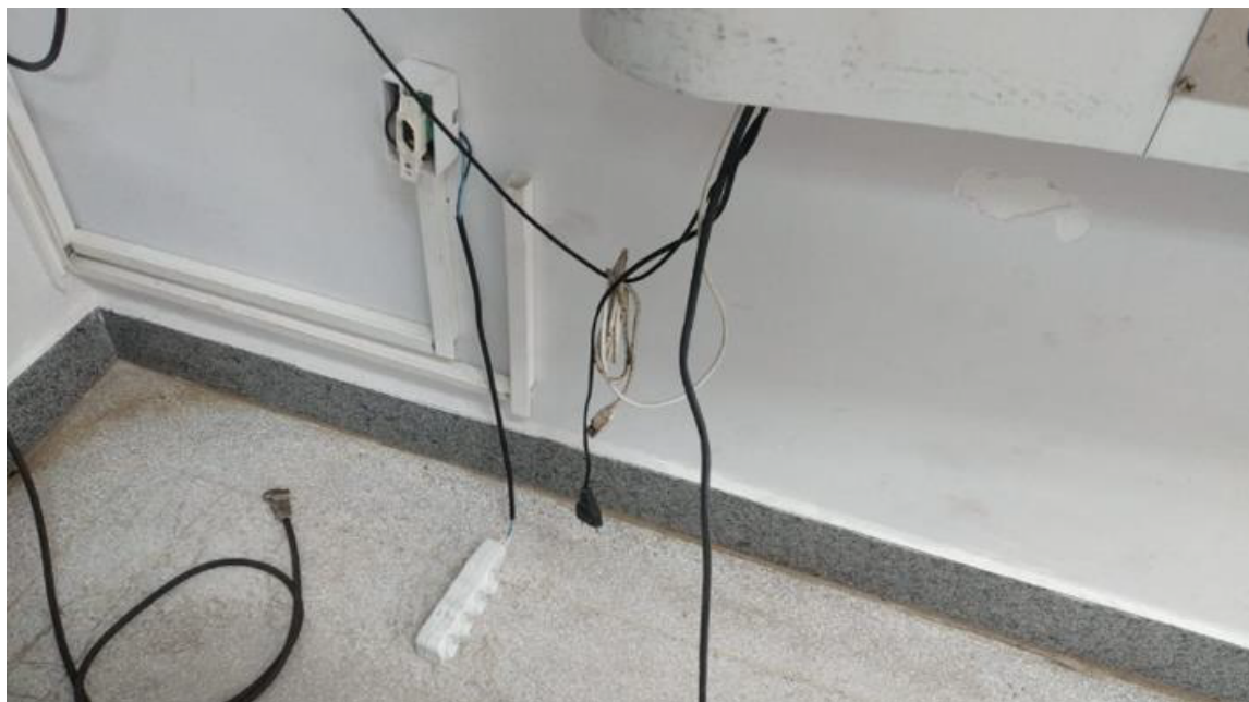
Figura 4.7: Condutores expostos perto das tomadas
