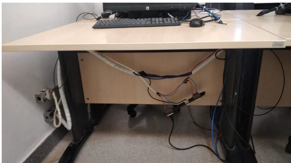
Figura 4.6: Condutor exposto embaixo da mesa
