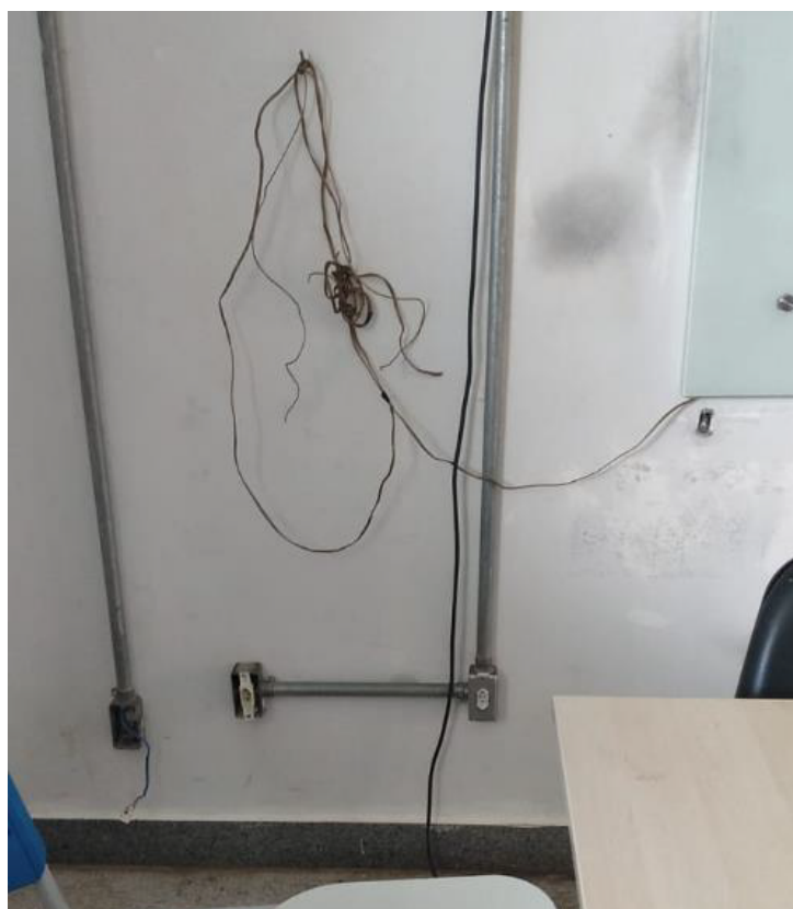
Figura 4.8: Pontos de tomadas em salas de aula
