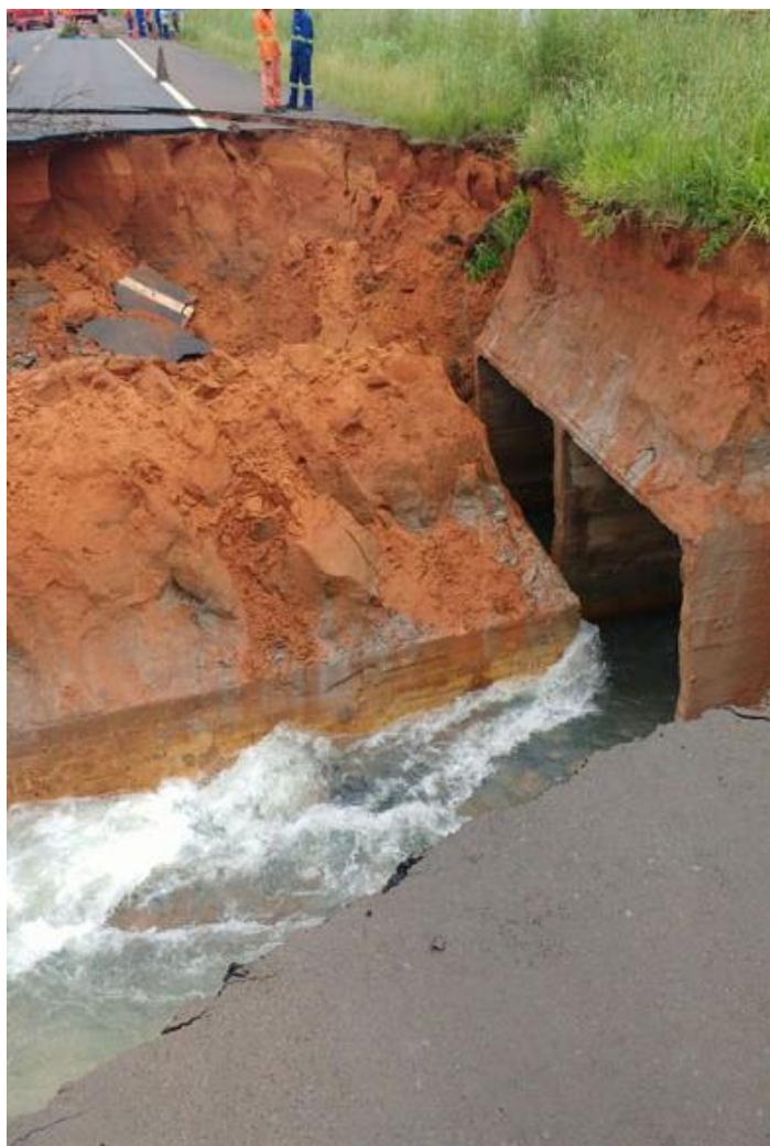
Figura 9: Erosão no Município de São Desidério – BA
