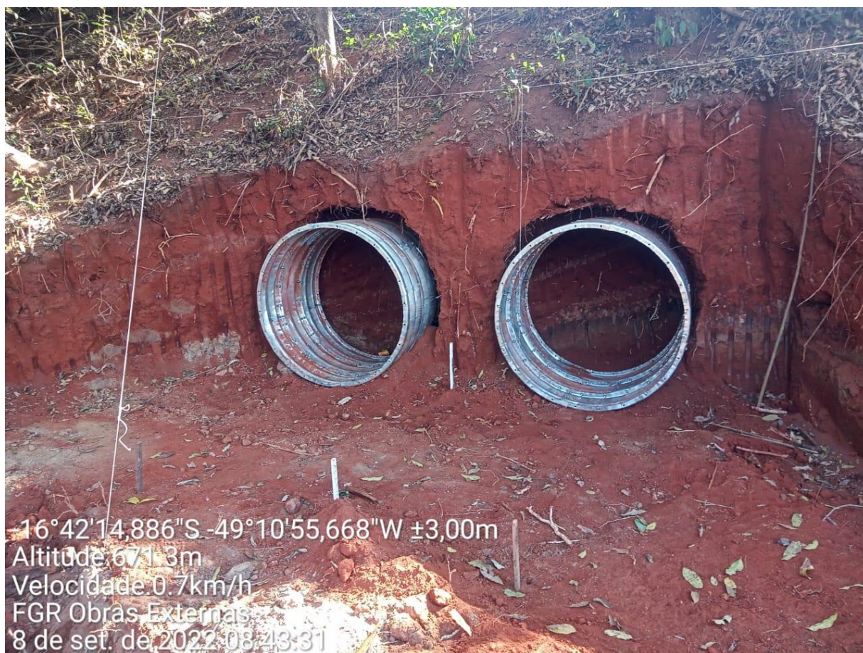
Figura 31: Emboque direto no talude
