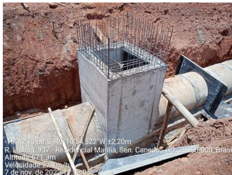
Figura 57: Caixa coletora de Sarjeta do BSTC
