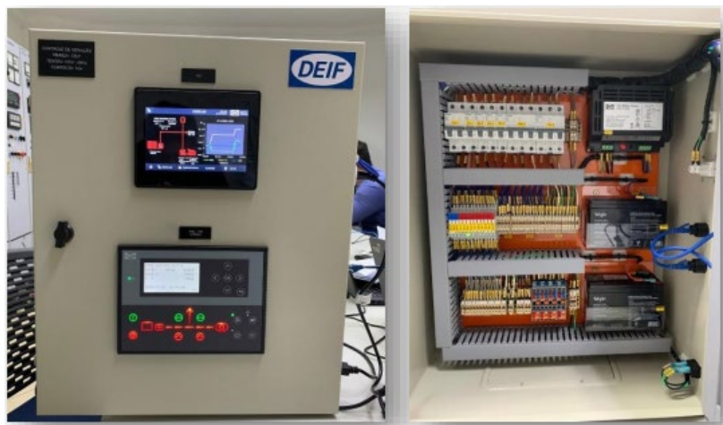
Figura 2 - Quadro de Transferência Automática (QTA)
