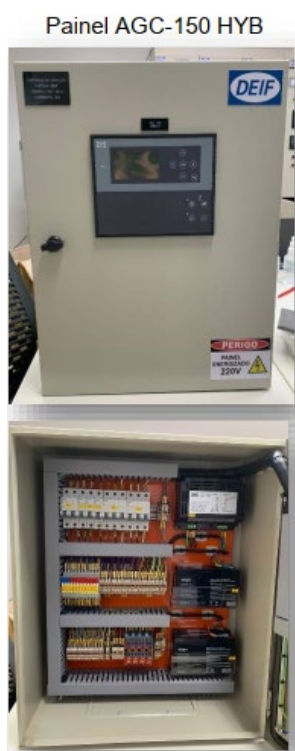
Figura 52 - Exemplo de painel elétrico contendo apenas a parte de comando elétrico do Quadro de Transferência Automática (QTA)
