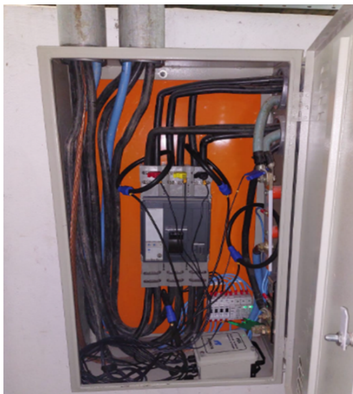
Figura 3.5: Instalação do Analisador de Energia
