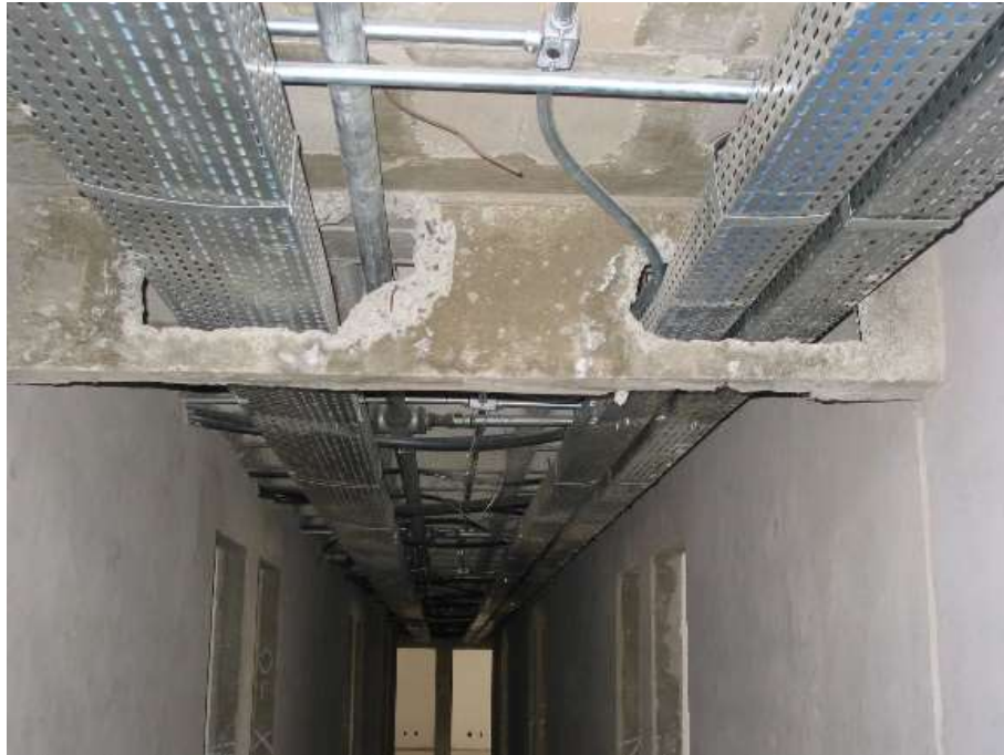
Figura 6 – Exemplo 2 de furação errada na viga.
