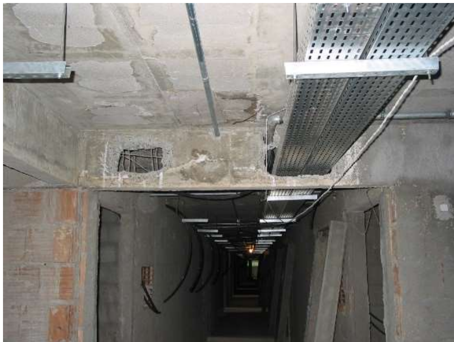
Figura 5 – Exemplo 1 de furação errada na viga.
