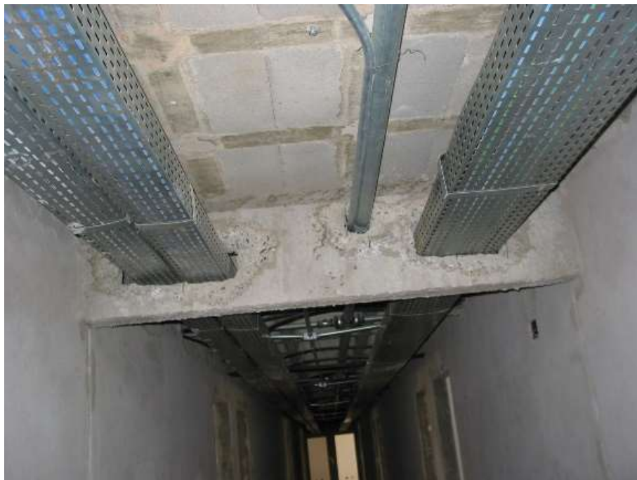
Figura 7 – Exemplo 3 de furação errada na viga.
