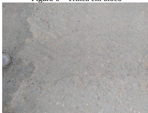
Figura 6 – Trinca em bloco
