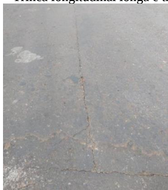
Figura 5 – Trinca longitudinal longa e transversal
