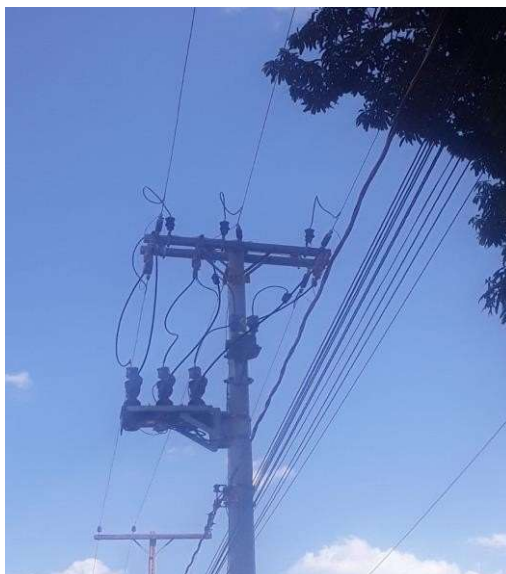
Figura 13: Instalação de Chave Telecomandada com Religador Automático concluída. Fonte: Arquivo Pessoal.
