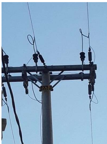
Figura 9: Estrutura de poste N4 com dupla cruzeta e fiação de cabos multiplexados. Fonte: Arquivo Pessoal.
