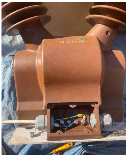
Figura 18: Ligação de TP utilizado na instalação de chave telecomandada. Fonte: Arquivo Pessoal.
