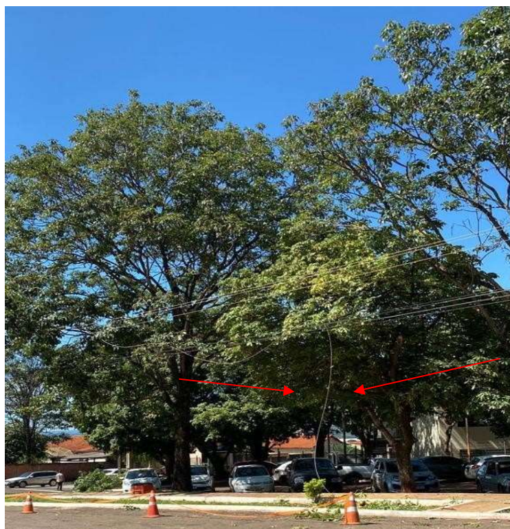
Figura 24: Rompimento de cabo da rede secundária de distribuição em manutenção da Linha Viva em Jataí-GO. Fonte: Arquivo Pessoal.
