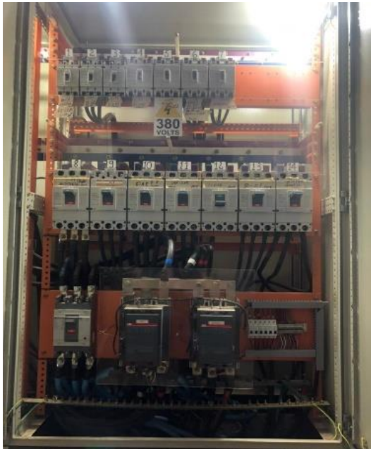
Figura 4 2 – QGF-1: Quadro Geral de Força 1.
