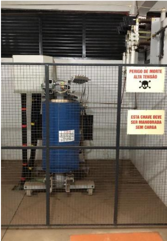
Figura 4 1 – Transformador 1, P=500 kVA, 13,8/0,38 kV.
