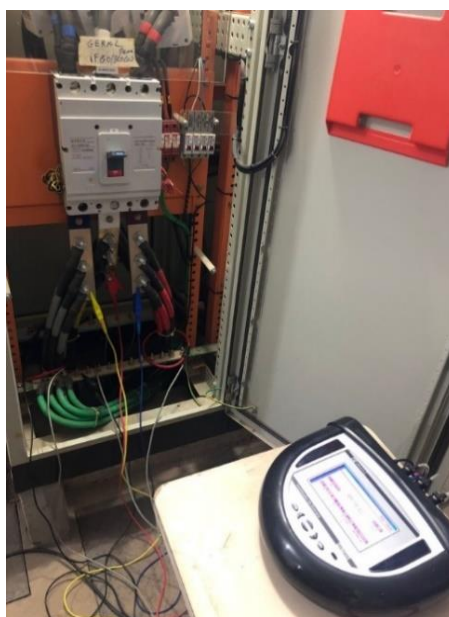
Figura 4.5 – Detalhe das medições realizadas no ponto de medição M no QGF-1/ Transformador 1.
