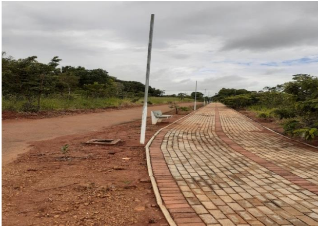
Figura 8: postes degradados faltando luminária.
