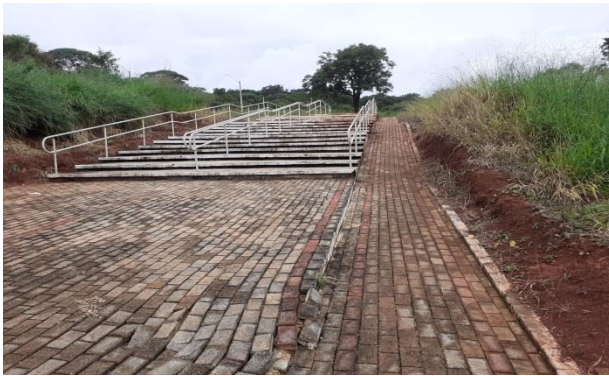
Figura 9: Escadaria abandonada com pintura mofada, blocos do piso soltos, capim crescendo.
