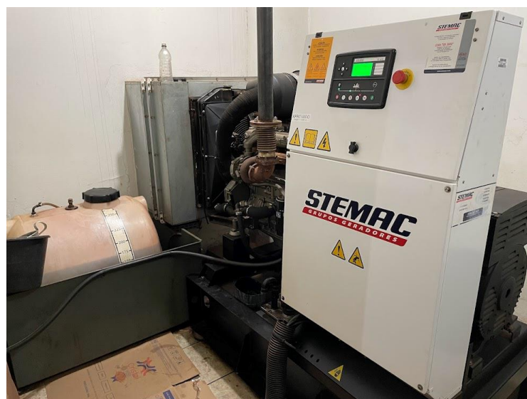
Figura 3 – Gerador do Supermercado.
