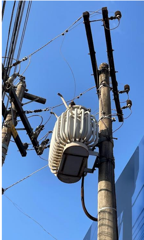
Figura 2 - Transformador da Subestação.
