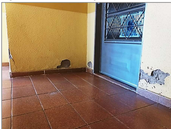
Figura 37 – Descolamento e pulverulência na entrada.
