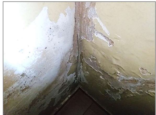
Figura 60 – Infiltração e mofo na sala 2.
