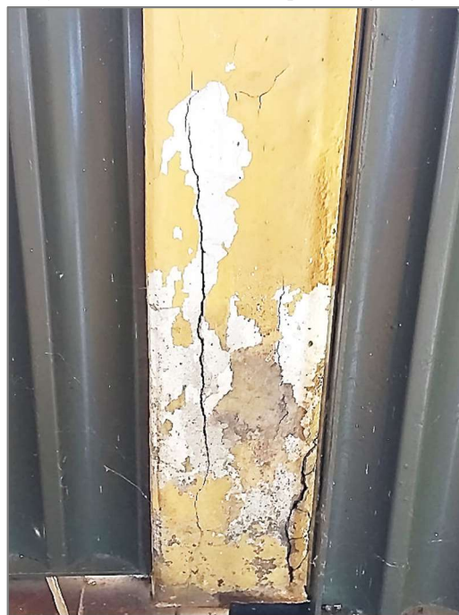
Figura 32 – Fissuração em pilar da garagem.
