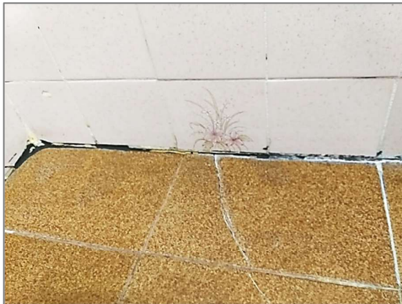
Figura 53 – Fissuração de piso no banheiro.
