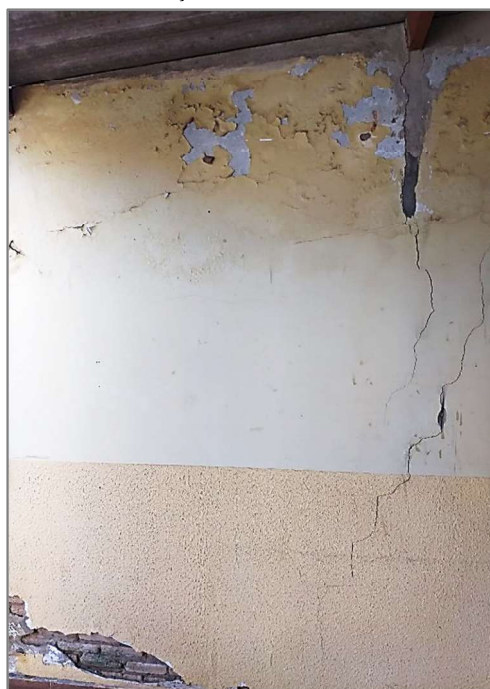
Figura 64 – Fissuração e descolamento na área social.
