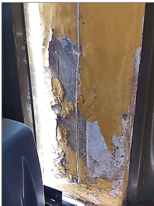
Figura 31 – Fissuração em pilar da garagem.
