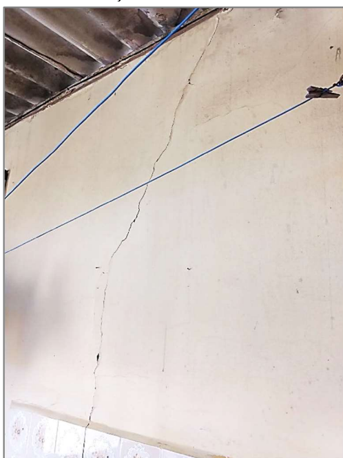
Figura 69 – Fissuração em alvenaria na área de serviço.
