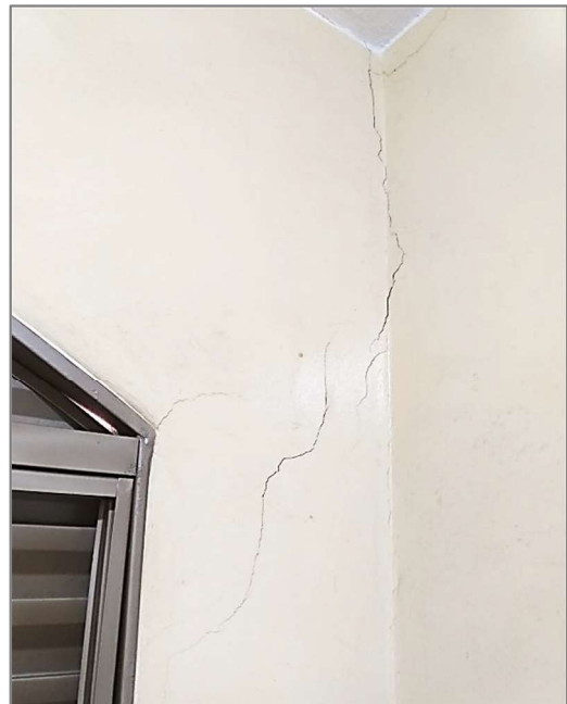
Figura 50 – Fissuração em canto de parede no quarto 2.
