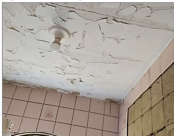
Figura 56 – Infiltração por condensação no banheiro.
