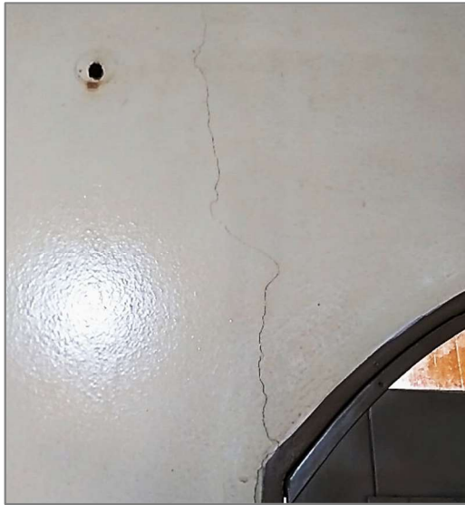
Figura 39 – Fissuração no contorno da porta da sala 1.
