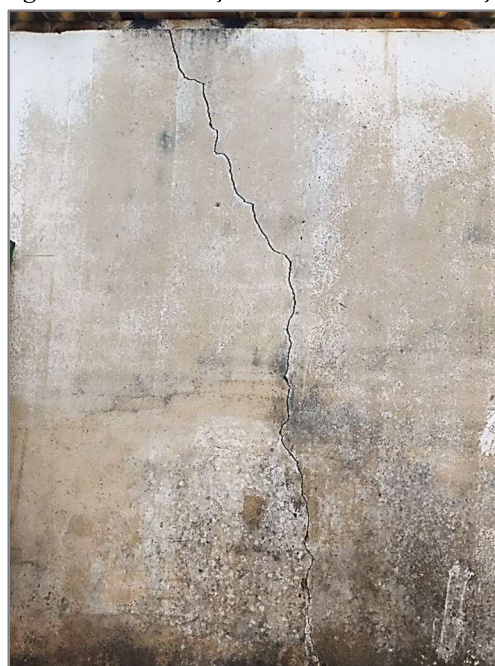
Figura 70 – Fissuração atrás da área de serviço.
