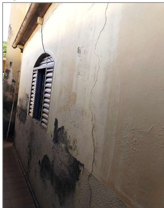
Figura 79 – Fissuração e infiltração no corredor.
