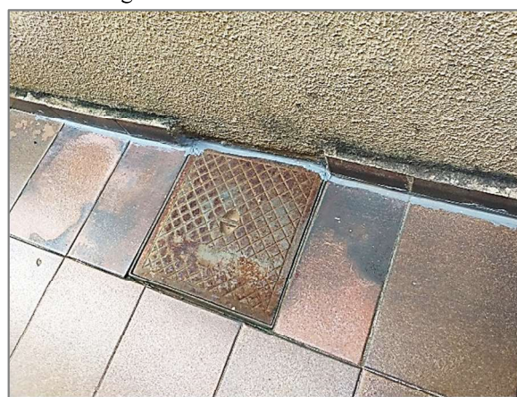
Figura 80 – Infiltração e manchas na caixa de esgotamento sanitário do corredor.
