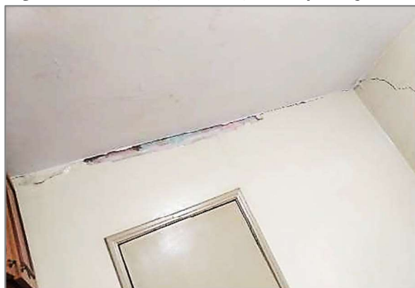
Figura 46 – Fissuração e dilatação de laje no quarto 1.
