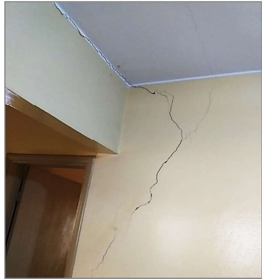
Figura 40 – Fissuração na alvenaria e laje da sala 1.
