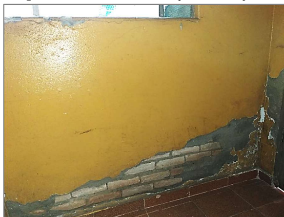
Figura 74 – Descolamento em placas no depósito.
