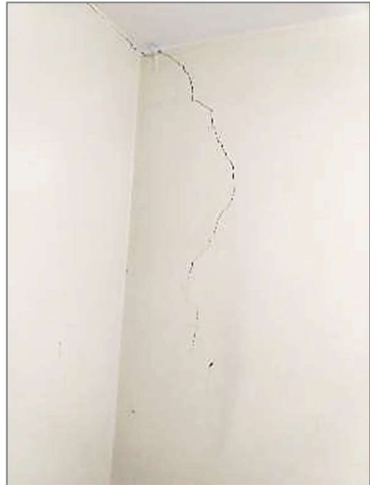
Figura 43 – Fissuração em alvenaria no quarto 1.
