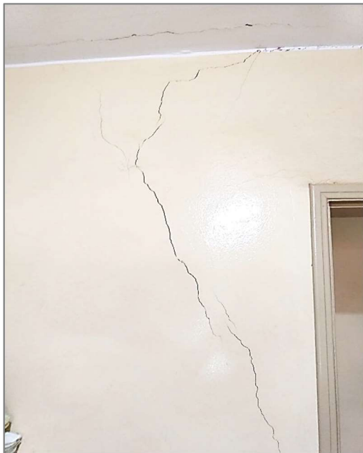
Figura 49 – Fissuração em alvenaria no quarto 2.
