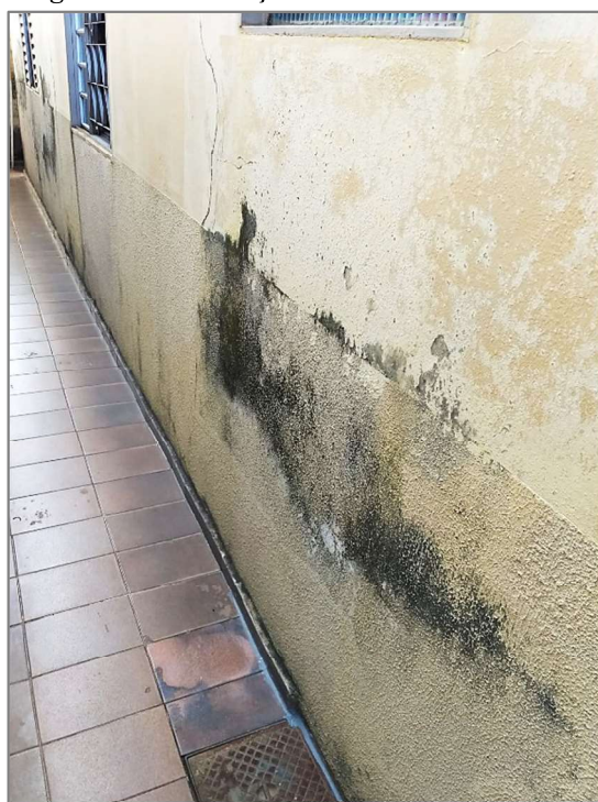
Figura 78 – Infiltração ascensional no corredor.
