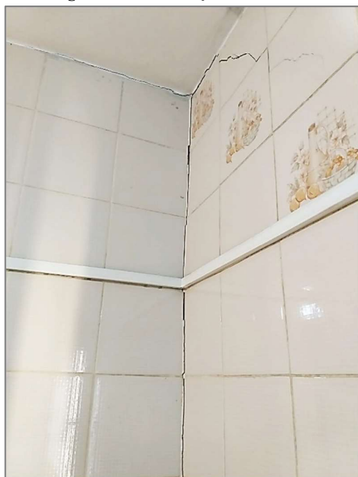
Figura 61 – Fissuração na cozinha.
