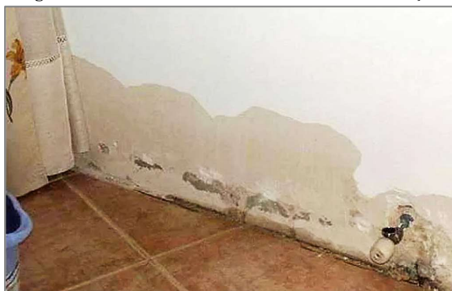
Figura 11 – Desenvolvimento de manchas em edificação.
