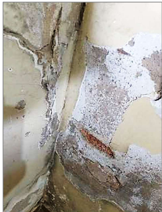
Figura 45 – Infiltração ascendente no quarto 1.
