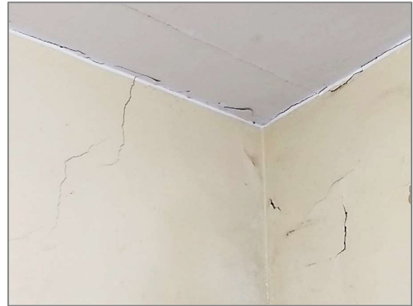
Figura 52 – Fissuração e descolamento no quarto 3.
