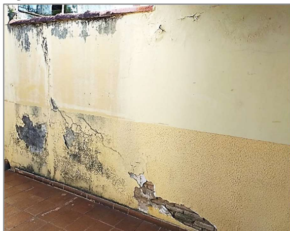
Figura 65 – Descolamento e mofo na área descoberta.
