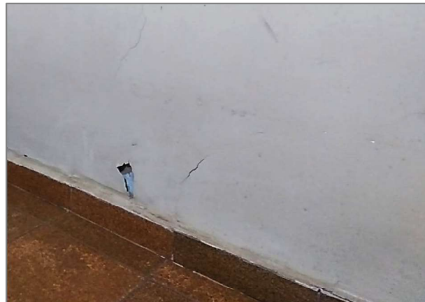
Figura 41 – Descolamento de argamassa na sala 1.
