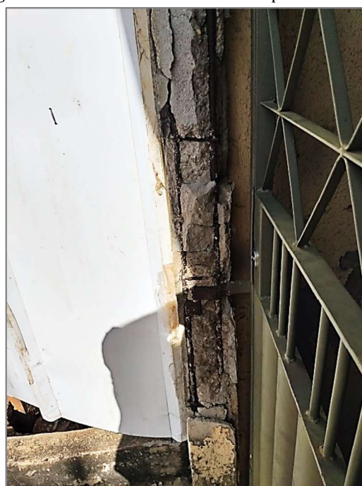
Figura 30 – Corrosão de armadura no pilar da fachada.
