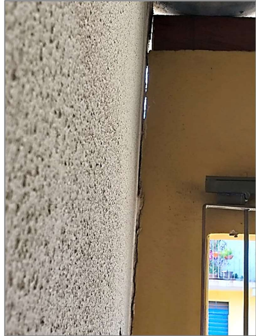
Figura 34 – Deslocamento de parede na garagem.
