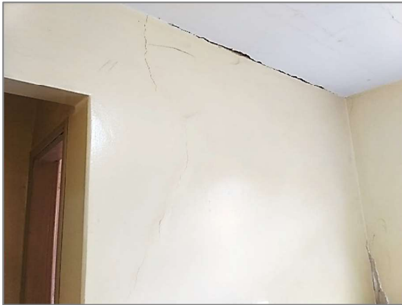
Figura 57 – Fissuração de parede e laje na sala 2.
