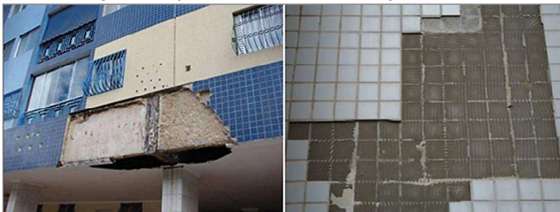
Figura 16 – Deslocamento localizado do emboço e de peças cerâmicas.
