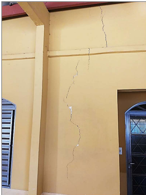
Figura 35 – Fissuração na entrada do imóvel.
