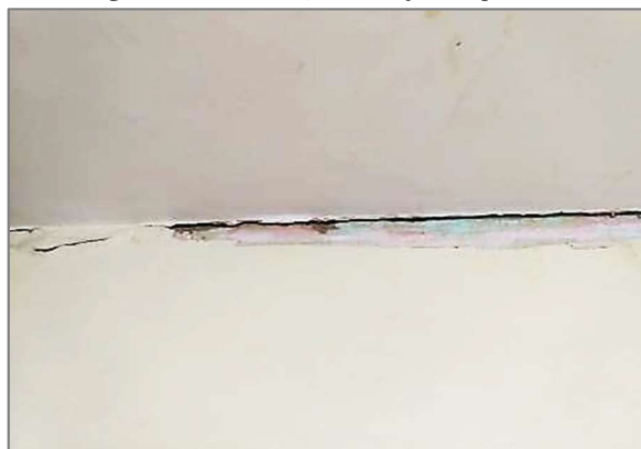
Figura 47 – Dilatação da laje no quarto 1.
