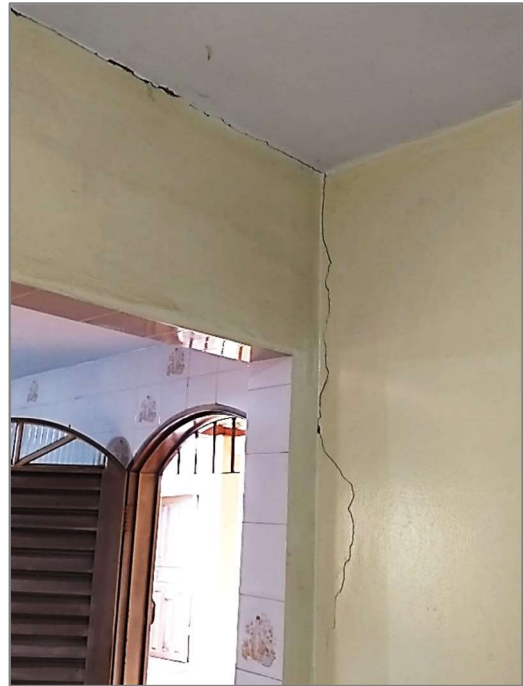
Figura 59 – Fissuração de canto e laje na sala 2.
