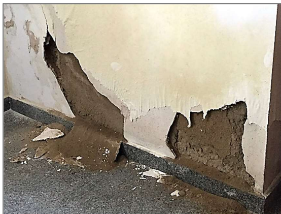
Figura 15 – Descolamento com pulverulência em edificação.
