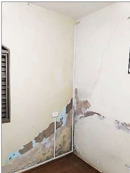
Figura 44 – Fissuração e infiltração no quarto 1.
