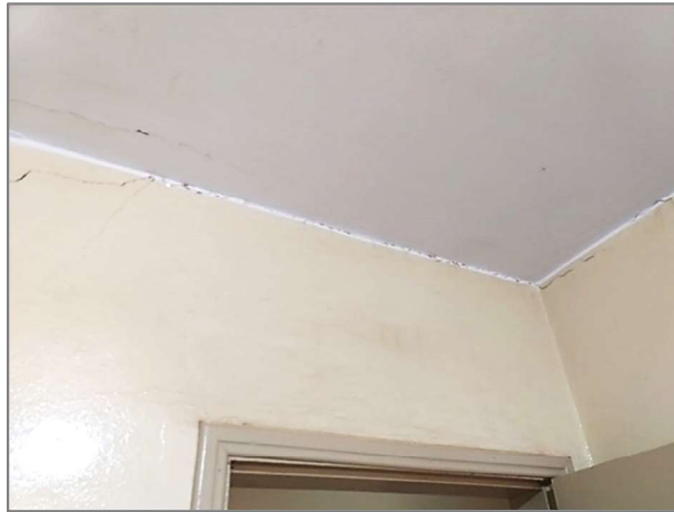
Figura 48 – Fissuração em alvenaria e laje no quarto 2.
