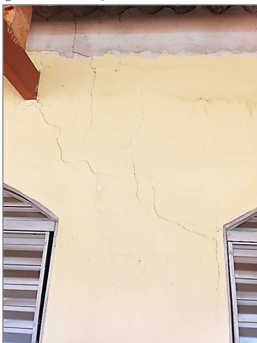
Figura 63 – Fissuração em alvenaria na área social.
