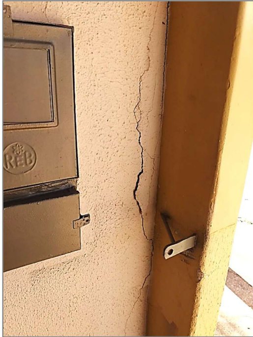
Figura 33 – Descolamento em placas na garagem.
