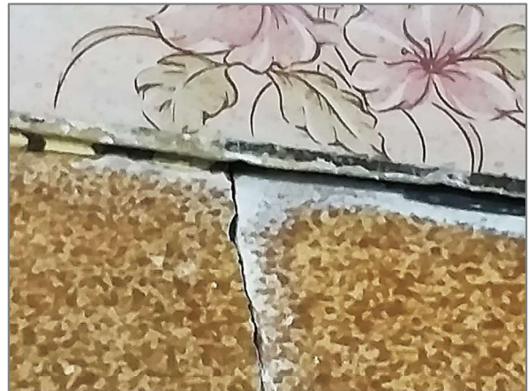
Figura 54 – Falha de rejuntamento no banheiro.
