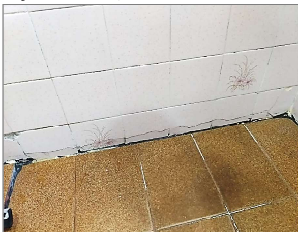
Figura 55 – Fissuração de revestimento no banheiro.
