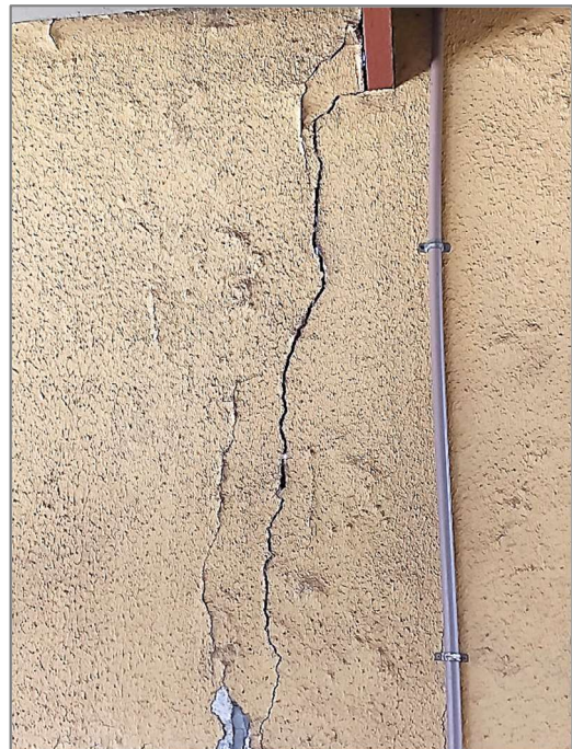
Figura 36 – Fissuração na parede lateral da garagem.
