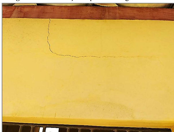
Figura 28 – Fissuração superior na viga da fachada.
