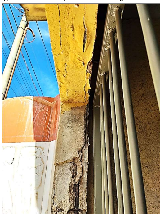
Figura 29 – Fissuração inferior na viga da fachada.
