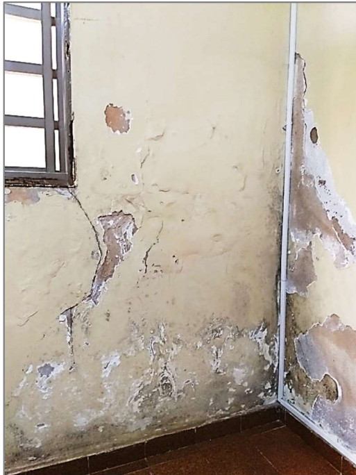
Figura 58 – Fissuração e infiltração na sala 2.
