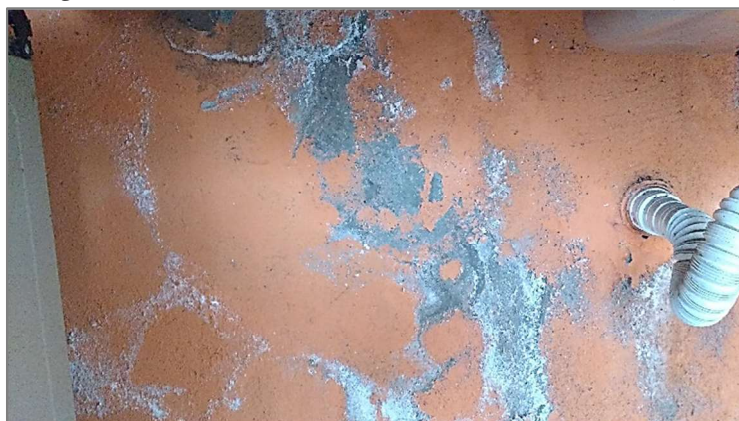
Figura 13 – Sintoma de eflorescência instaurado na edificação.
