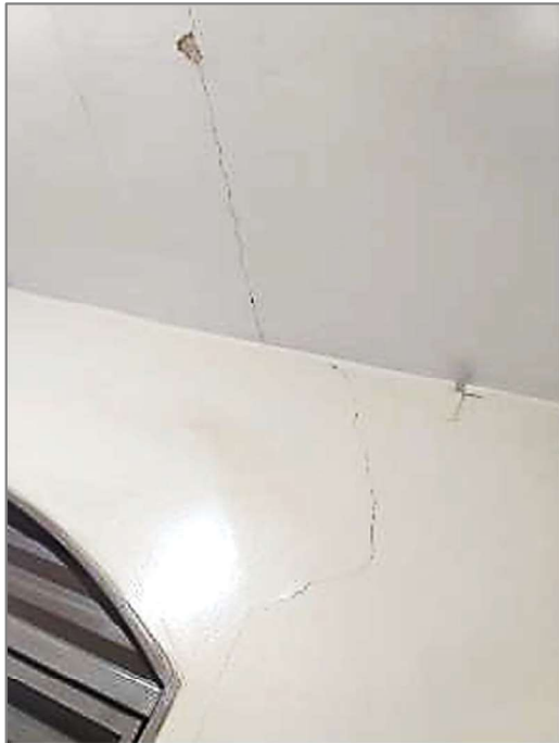
Figura 42 – Fissuração em alvenaria e laje no quarto 1.
