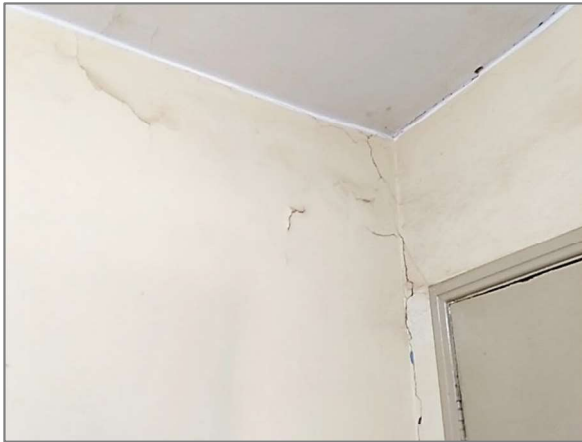
Figura 51 – Fissuração de alvenaria no quarto 3.
