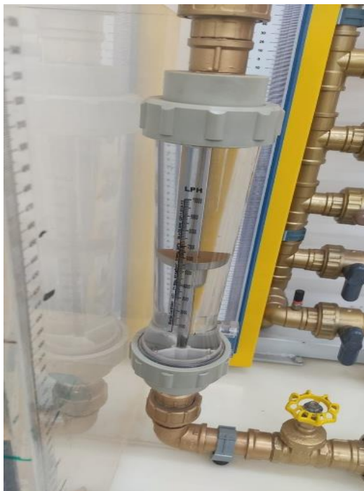
Figura 8 – Rotâmetro, Medidor de Vazão, marcando 5200 LPH. Fonte: Autor, 2023.
