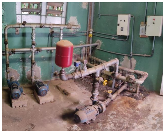
Figura 5 - Casa de Máquinas central, abaixo da caixa d'água. Fonte: Autor, 2023.
