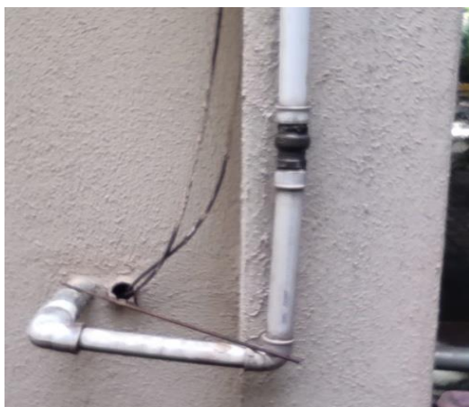
Figura 4 - Descida da caixa d'água central, tubulação de 1.1/4". Fonte: Autor, 2023.
