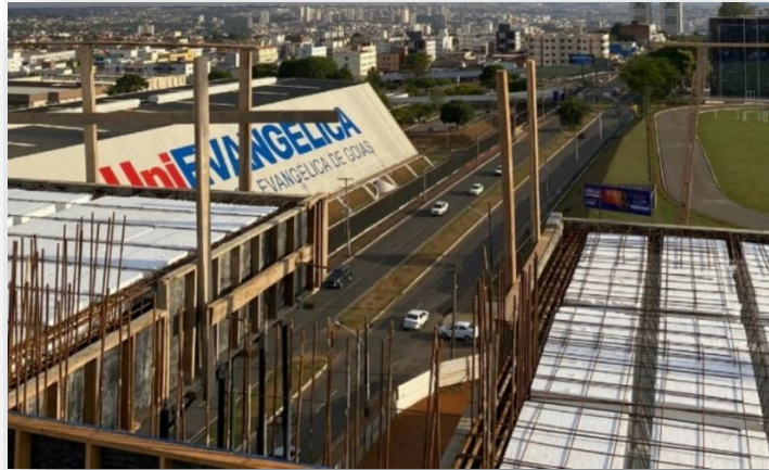
Figura 18: Guarda corpo irregular
