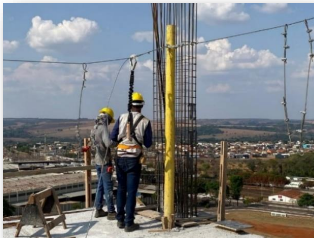
Figura 29: Armador ancorado na linha de vida
