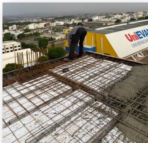
Figura 21: Falta do guarda corpo, rodapé e cinto de segurança
