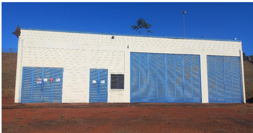
Figura 10 – Local de instalação do Banco de Capacitores
