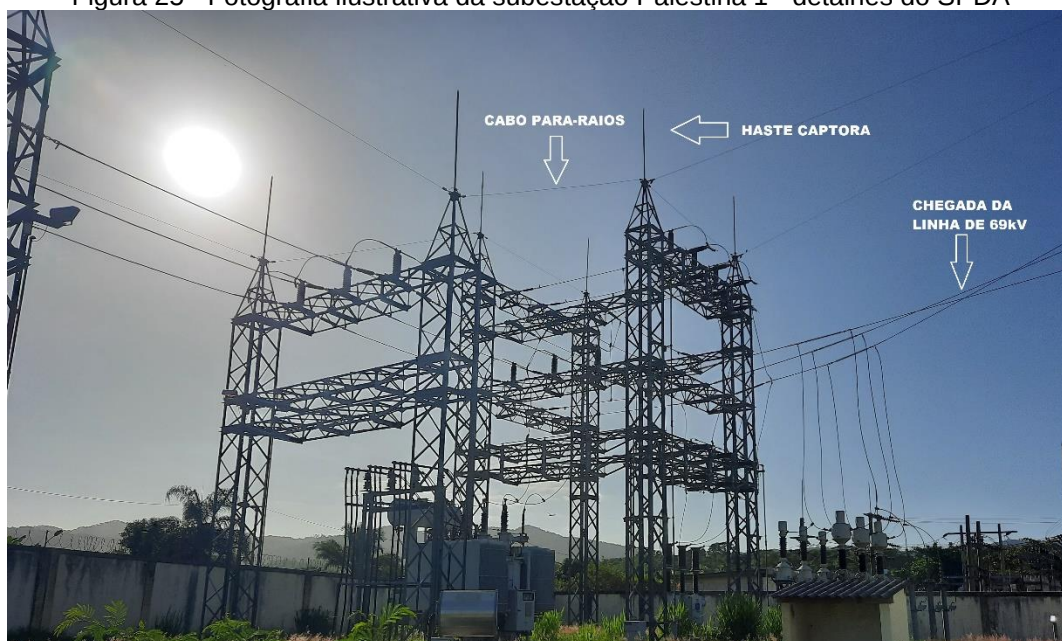
Figura 25 - Fotografia ilustrativa da subestação Palestina 1 - detalhes do SPDA
