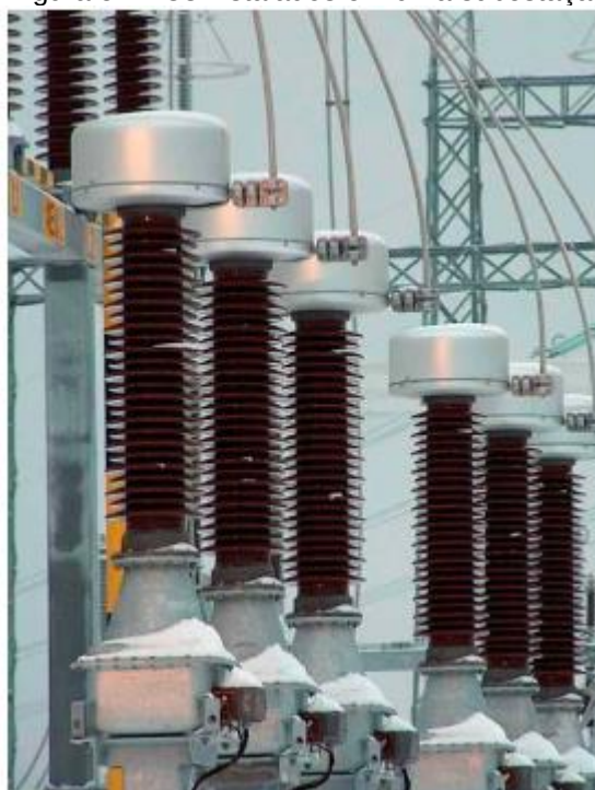
Figura 5-TPCs instalados em uma subestação
