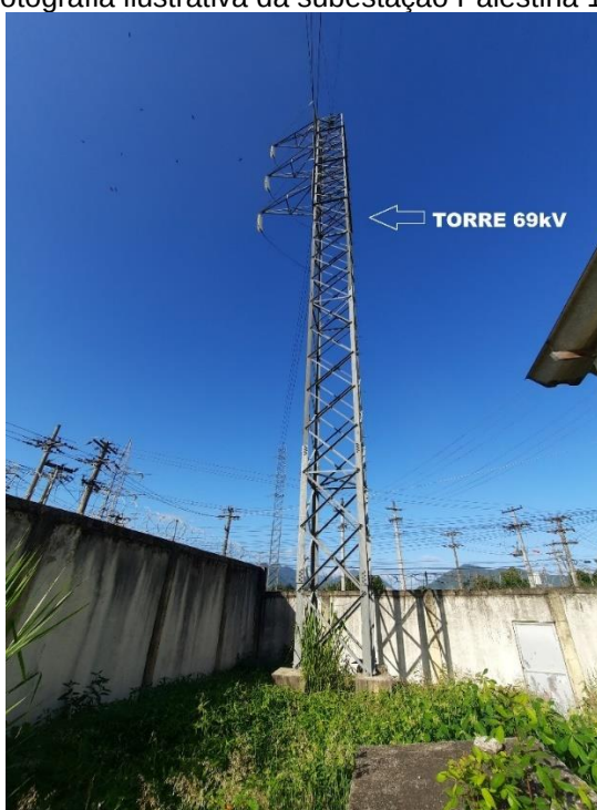
Figura 27 - Fotografia ilustrativa da subestação Palestina 1 - Torre 69 kV
