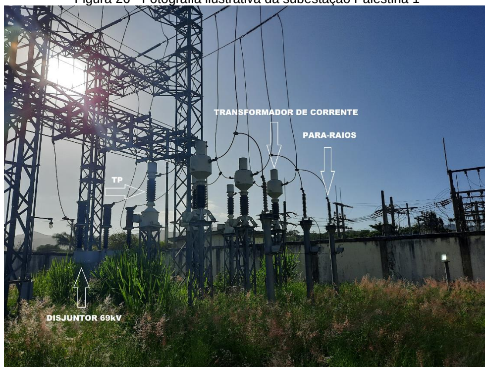
Figura 26 - Fotografia ilustrativa da subestação Palestina 1
