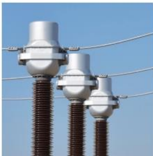
Figura 6 - Transformadores de Corrente em campo
