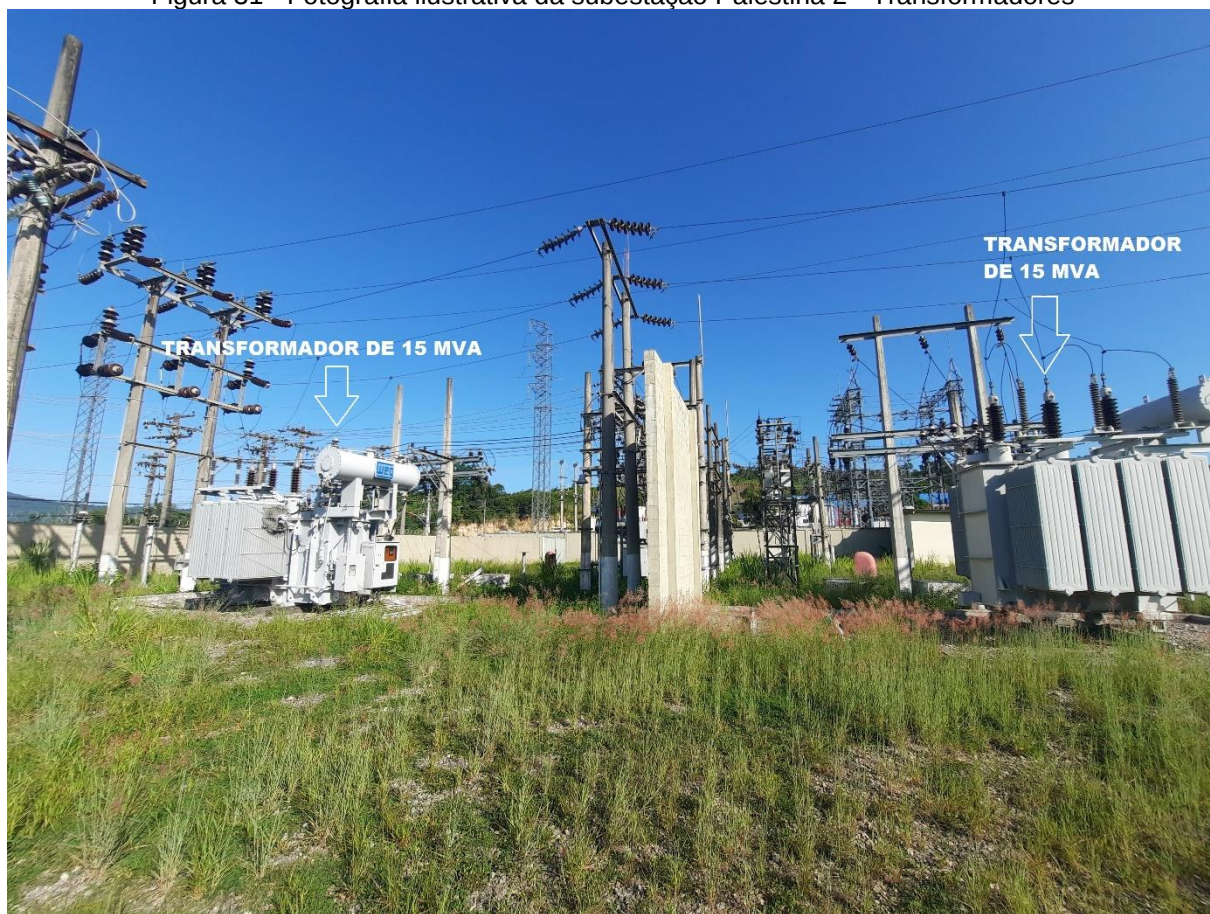
Figura 31 - Fotografia ilustrativa da subestação Palestina 2 - Transformadores
