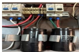
Figura 15 - Banco de capacitores
