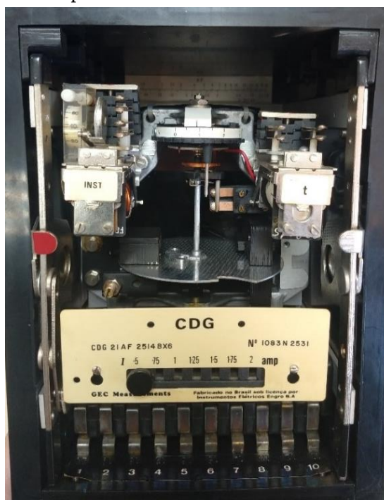
Figura 2 - Relé eletromecânico temporizado de sobrecorrente.
