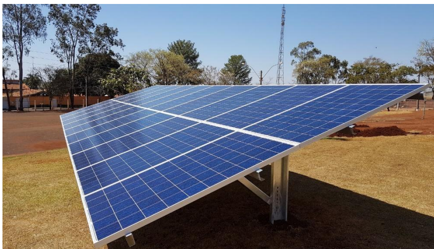
Figura 30 - Instalação Fotovoltaica do IFG Campus Itumbiara
