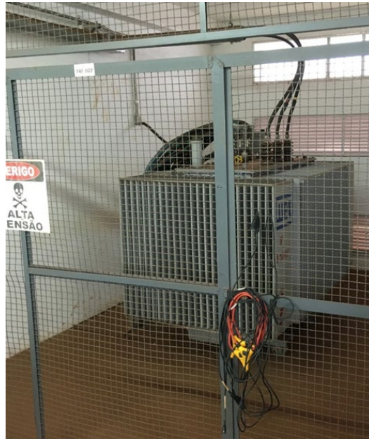
Figura 29- Transformador utilizado para coleta dos dados.
