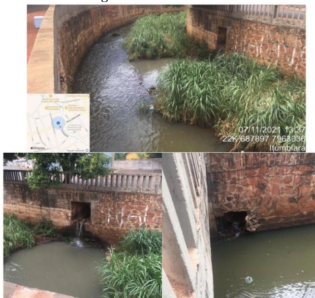
Figura 14 – Descarte de efluentes no córrego Trindade
