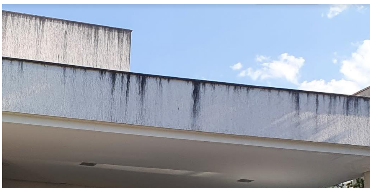
Figura 74 — Manchas na fachada devido a umidade
