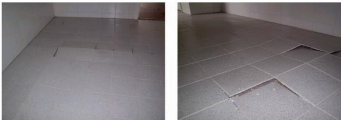
Figura 42 — Destacamento de piso cerâmico devido à excessiva deformação da laje
