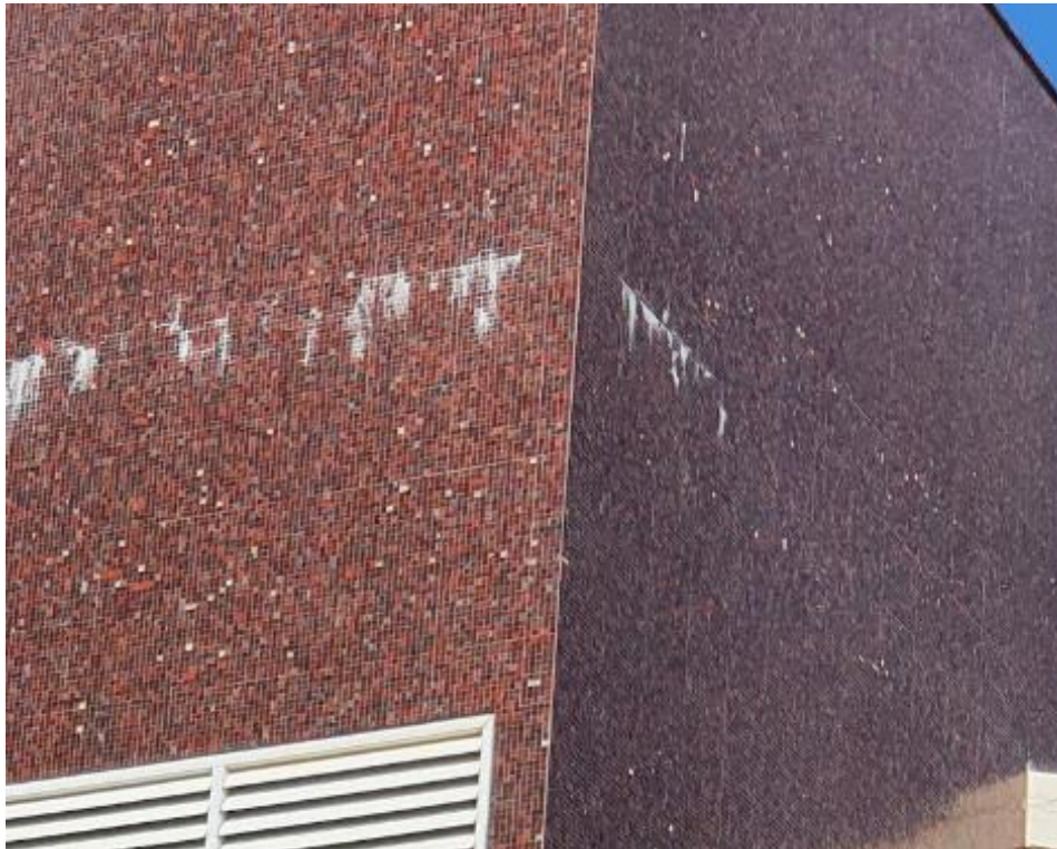
Figura 78 — Eflorescências no revestimento externo da edificação
