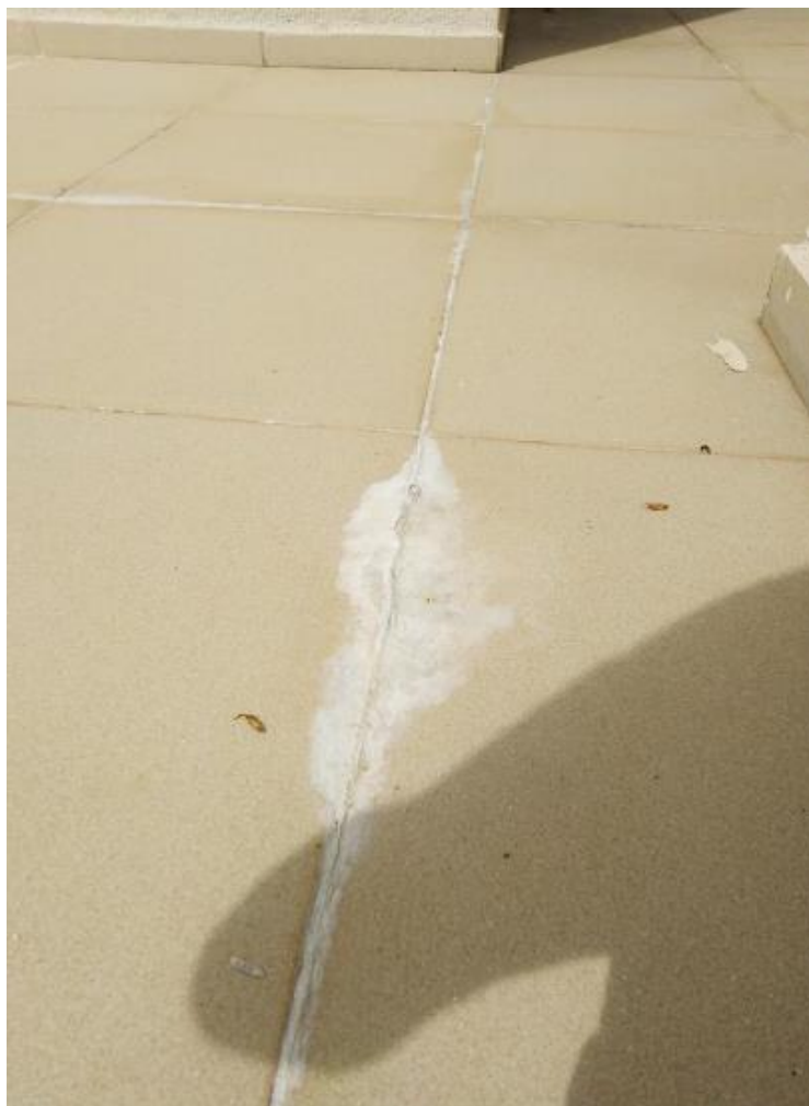
Figura 69 — Eflorescência no rejunte e no piso
