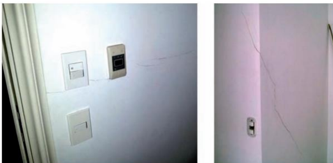
Figura 37 — Fissuras em alvenarias apoiadas sobre lajes de concreto armado
