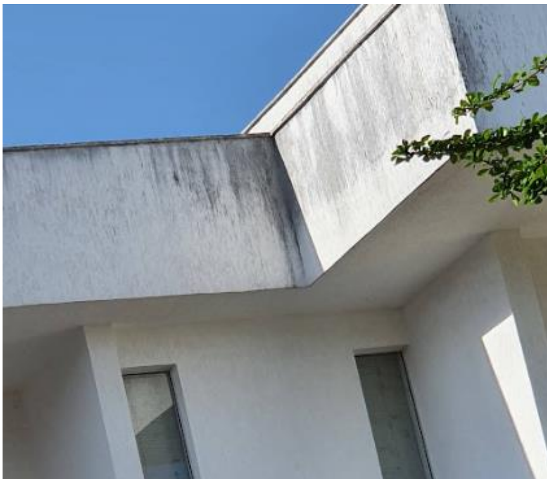
Figura 73 — Manchas devido a umidade
