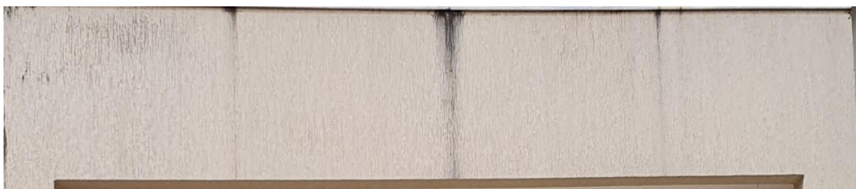
Figura 81 — Manchas de infiltração na platibanda
