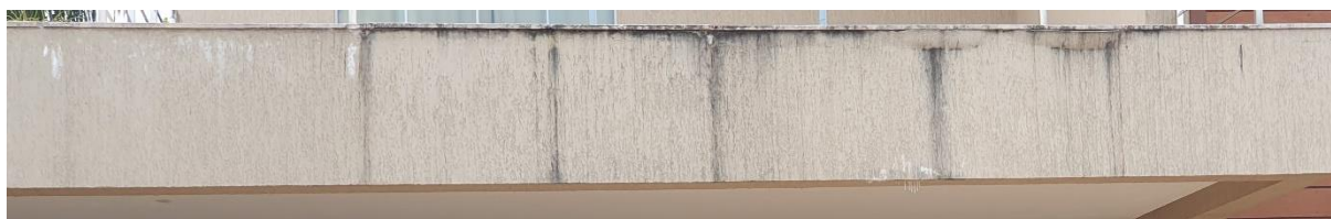
Figura 85— Presença de manchas e eflorescências, na fachada frontal da edificação
