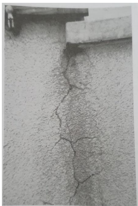
Figura 17 — Fissuração da argamassa de revestimento provocada pelo fluxo de água interceptado no peitoril da janela e que escorreu lateralmente a ele
