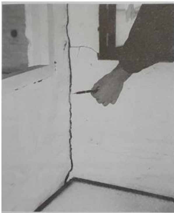
Figura 56 — Fissura de recalque vertical: as partes seccionadas da construção comportam-se individualmente como corpos rígidos
