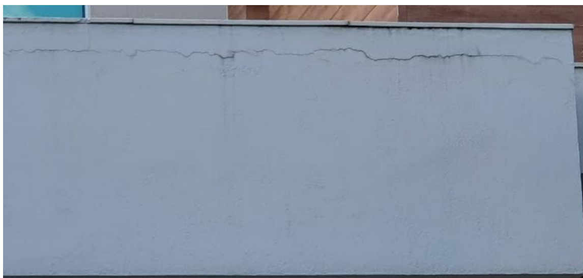
Figura 70 — Fissura em fachada abaixo da pingadeira
