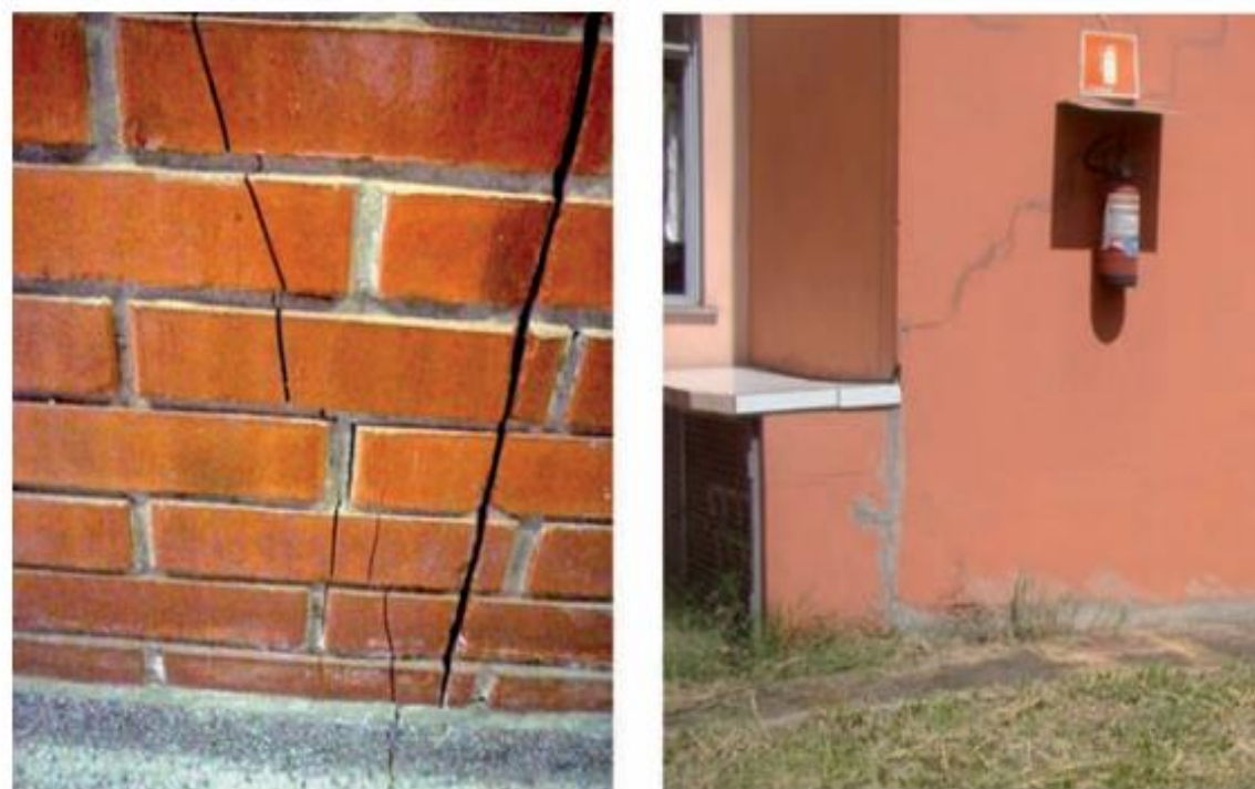
Figura 35 — Fissuras em alvenarias do pavimento térreo decorrentes de flechas em vigas baldrame
