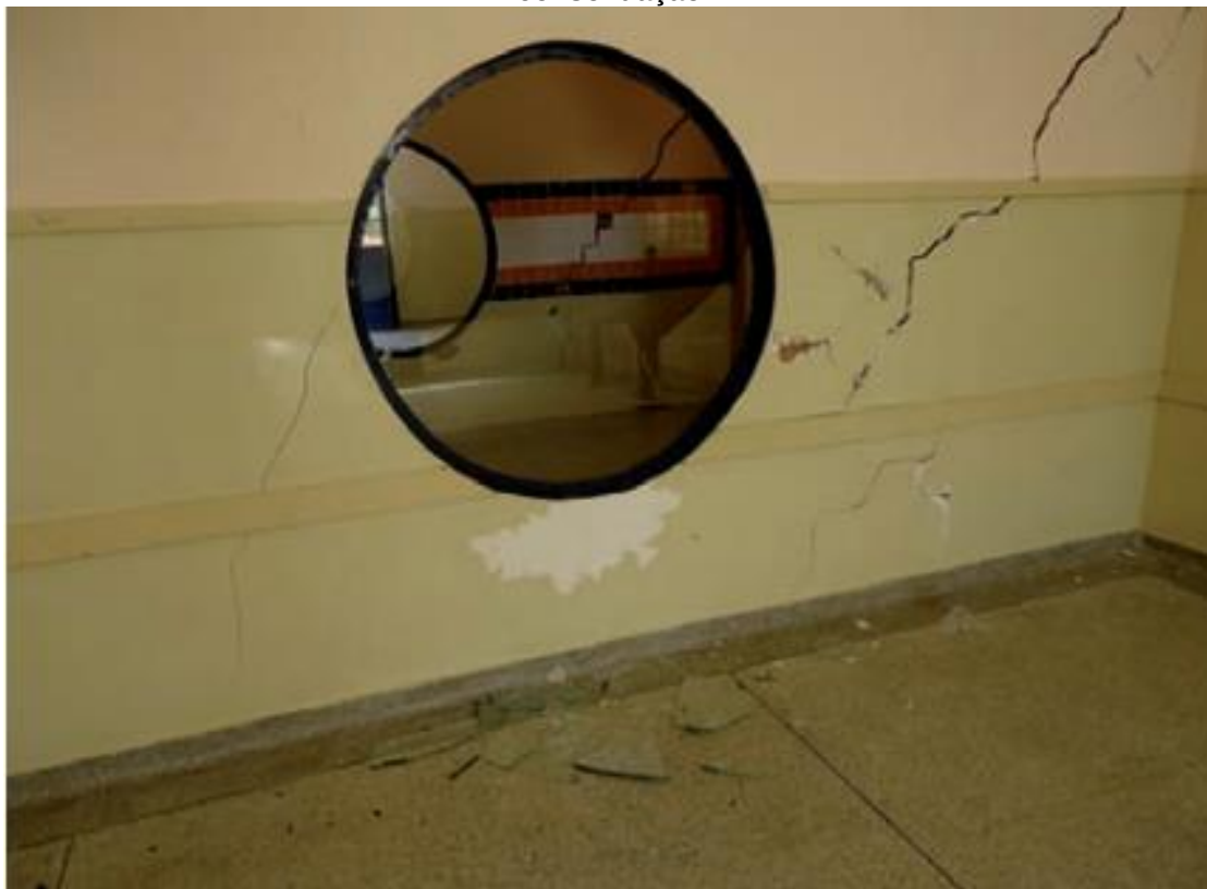
Figura 52 — Forte fissuração de alvenarias em obra construída sobre aterro em fase de consolidação
