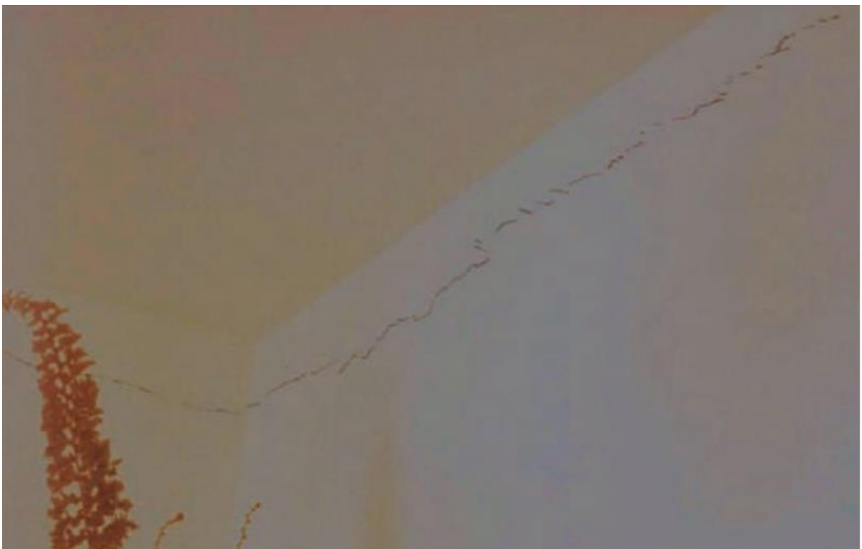
Figura 9 — Parede com fissuras inclinadas, em forma de “escama”, evidenciando a dilatação térmica da laje de cobertura)
