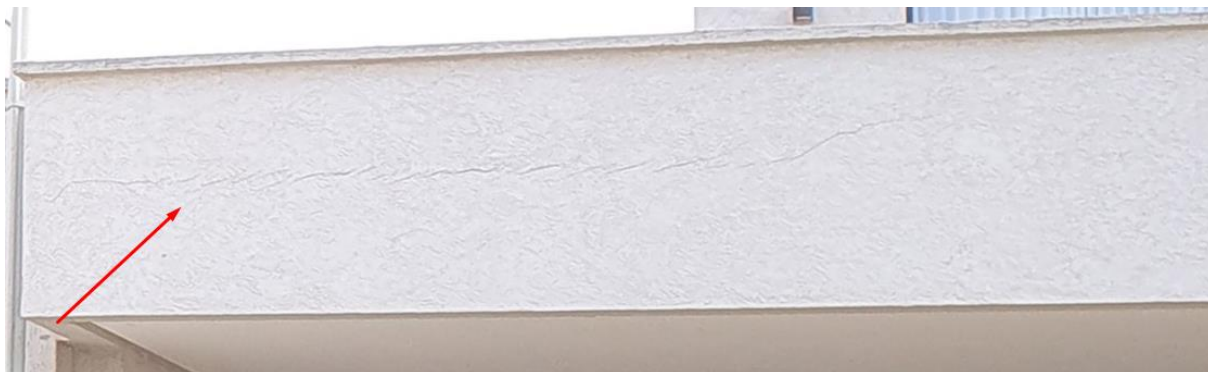
Figura 84 — Trinca por deformação excessiva na fachada frontal da residência
