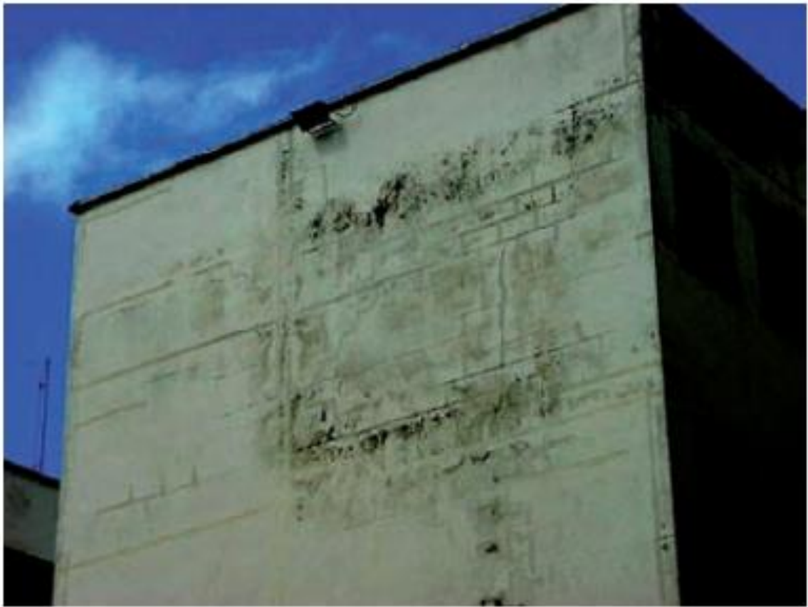
Figura 61 — Destacamentos entre blocos de concreto, argamassa de assentamento, e fissuras de retração na alvenaria
