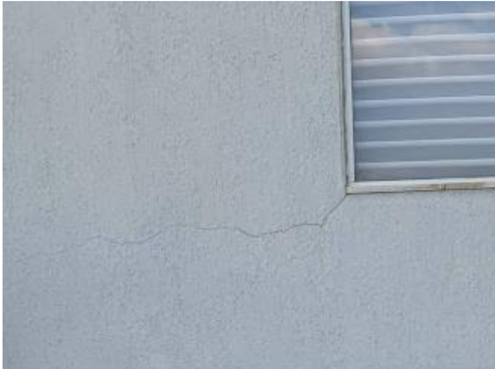
Figura 77 — Fissura inclinada abaixo da janela
