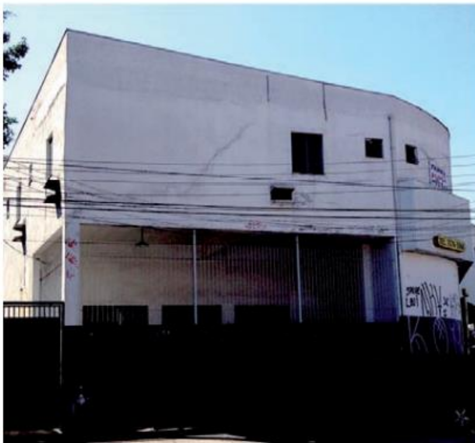
Figura 38 — Fissuras de flexão em alvenaria apoiada sobre viga de concreto armado
