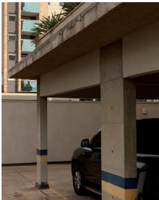
Figura 16 — Destacamento da argamassa no topo da laje/beiral, causado por expansão higroscópica da argamassa
