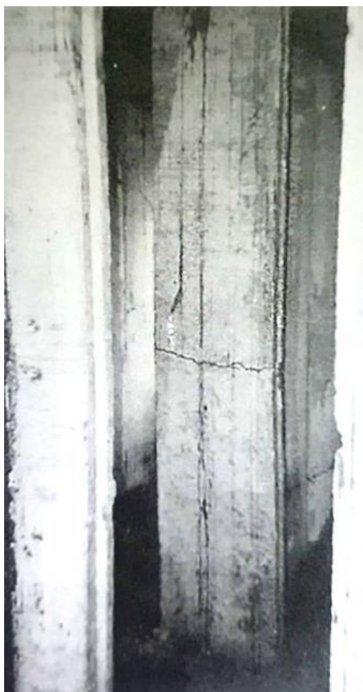
Figura 24 — Trincas horizontais a meia altura de painel pré moldado de concreto armado submetido à flexo compressão
