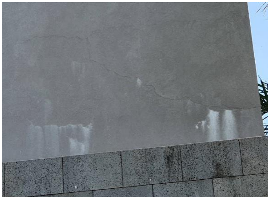
Figura 79 — Eflorescência na parede lateral da edificação
