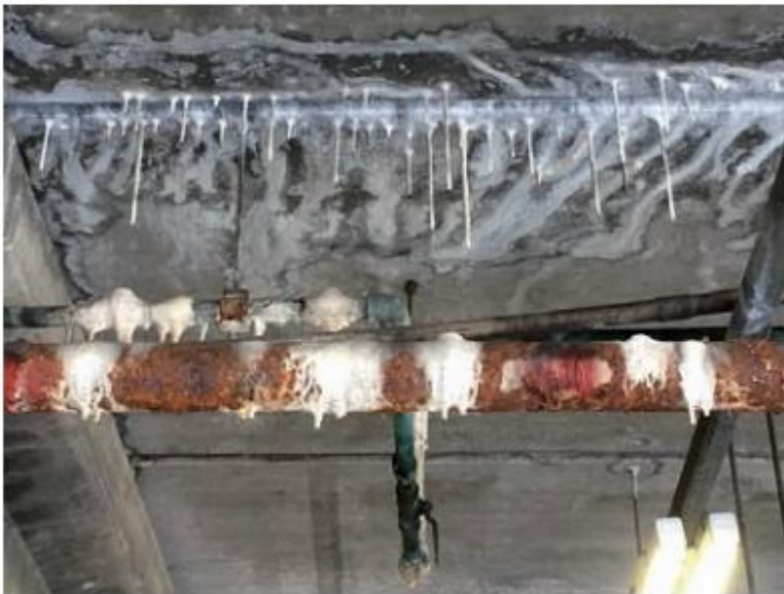
Figura 60 — Fissura de retração no capeamento da laje pré-fabricada facilita infiltração de água, lixiviação da cal e formação de carbonato de cálcio
