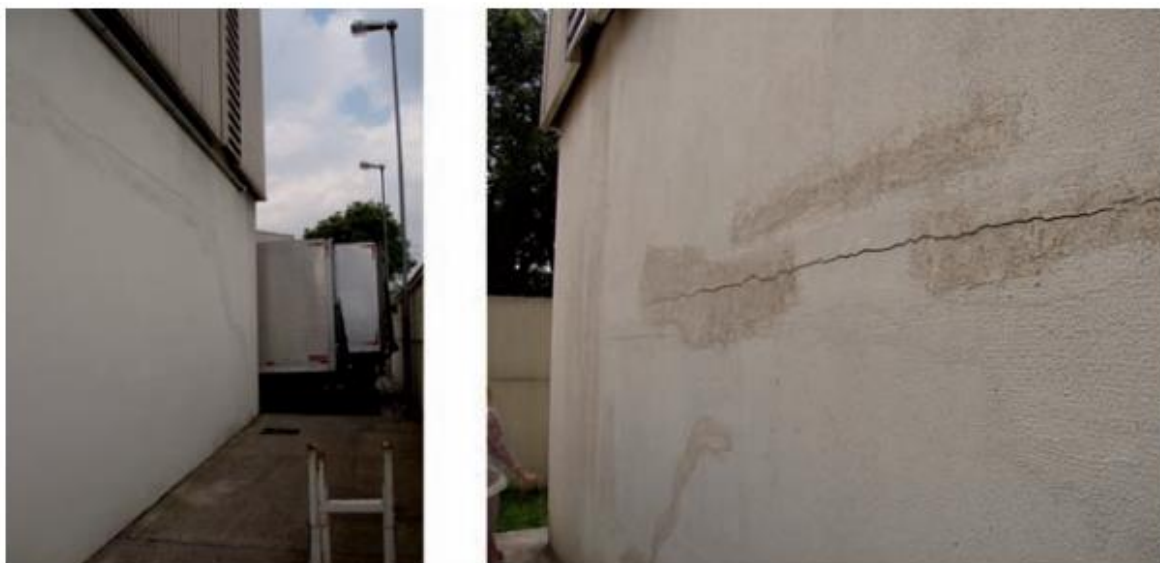
Figura 36 — Fissuras em alvenaria do pavimento térreo decorrentes de flecha na viga de fundação
