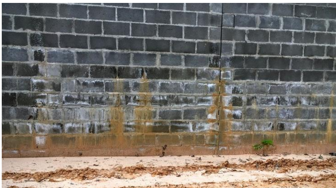
Figura 64 — Eflorescência em blocos de concreto
