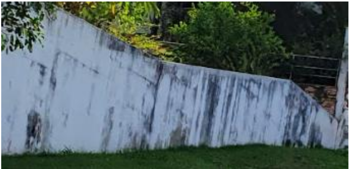
Figura 76 — Manchas e deslocamento no muro
