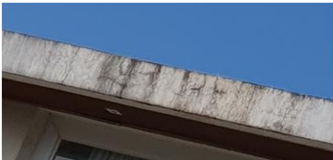
Figura 82 — Fissuras por movimentação higroscópica na fachada frontal da edificação
