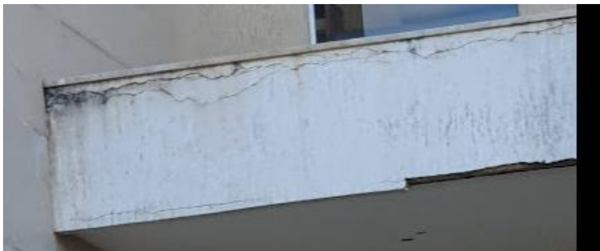
Figura 72 — Fissuras, deslocamento e manchas na fachada, abaixo da pingadeira
