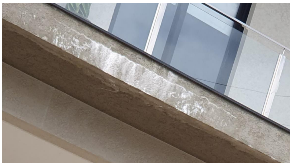
Figura 83 — Presença de eflorescência na platibanda
