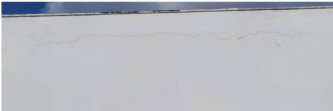
Figura 71 — Fissura abaixo da pingadeira
