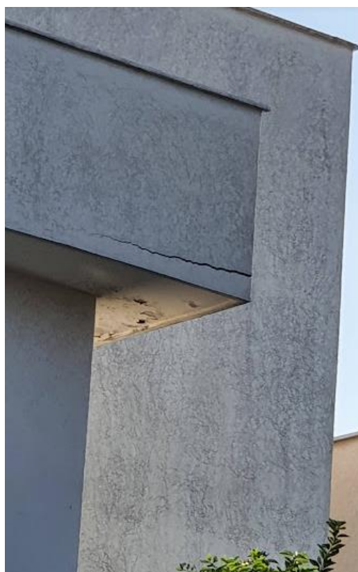
Figura 80 — Trinca na extremidade da platibanda
