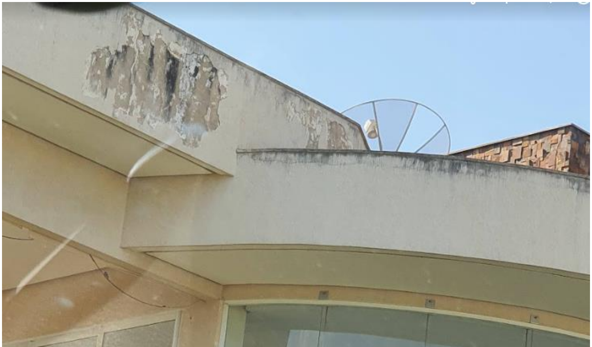
Figura 75 — Manchas e deslocamento da pintura na fachada
