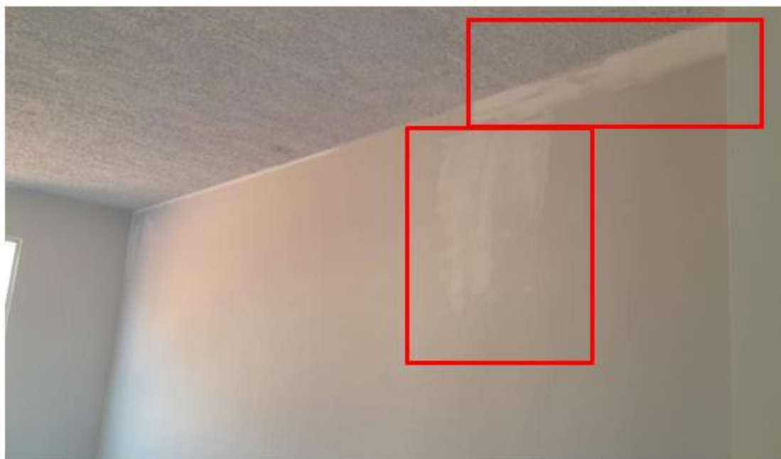
Figura 23 - Pinturas mal realizadas
