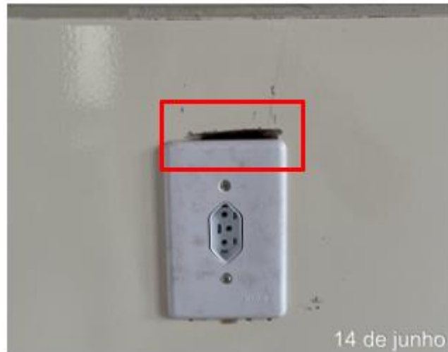
Figura 28 - Erro no corte do piso cerâmico
