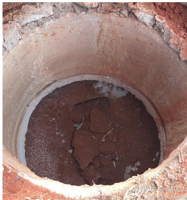
Figura 33 - Caixa de passagem de agua da chuva entupida
