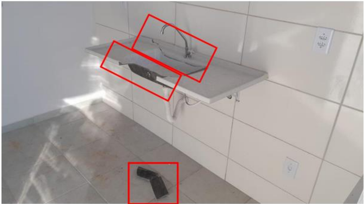
Figura 30 - Pia da cozinha quebrada
