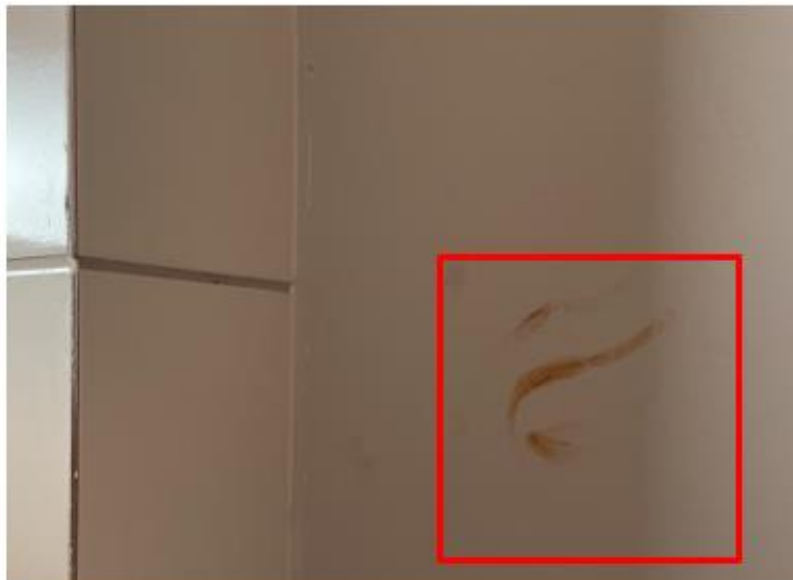
Figura 31 - Mancha na parede do banheiro
