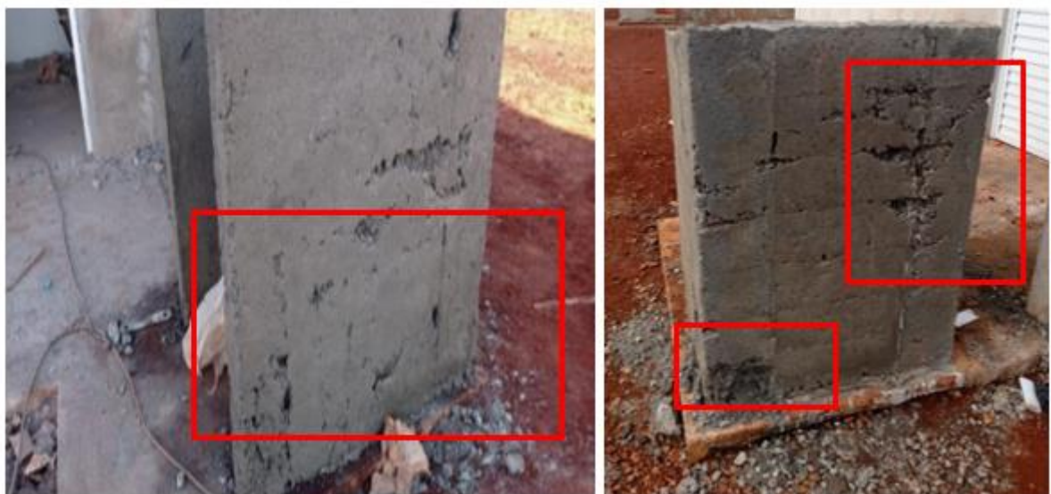
Figura 21 - Falhas na concretagem
