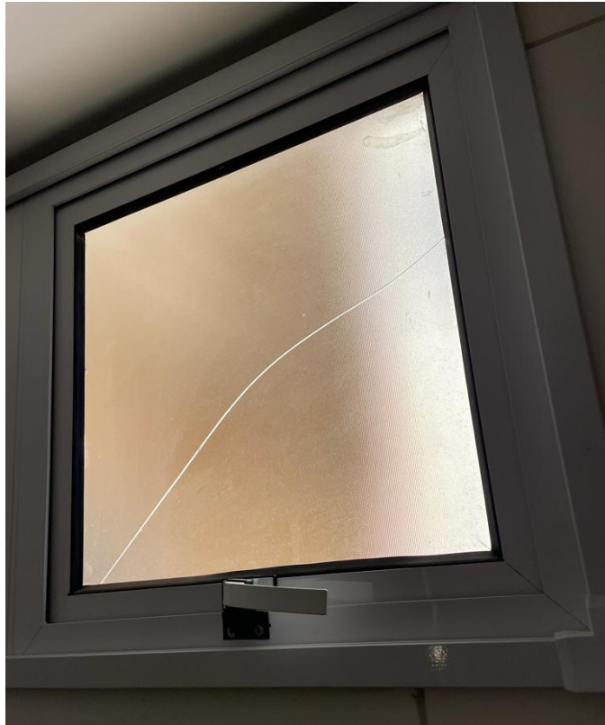
Figura 36 - Vidro da esquadria trincado
