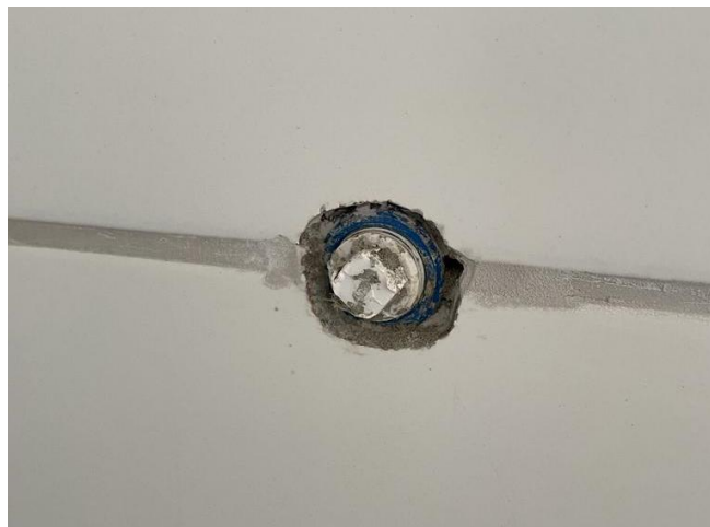
Figura 37 - Saída de água em rejuntar
