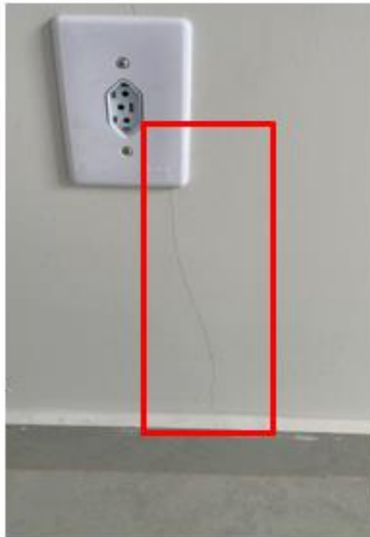
Figura 25 - Fissura proximo a tomada
