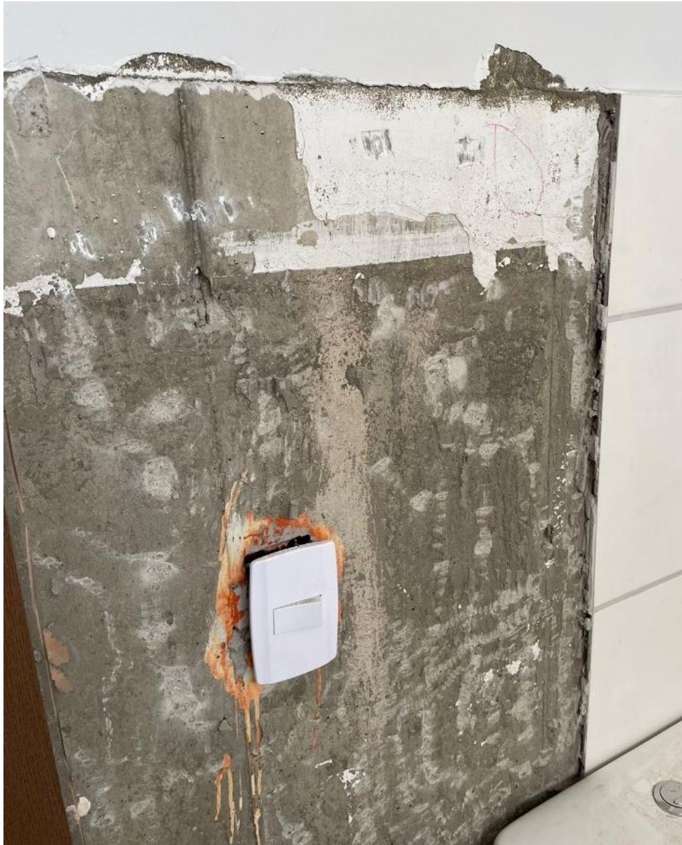
Figura 38 - Deslocamento de peça cerâmica
