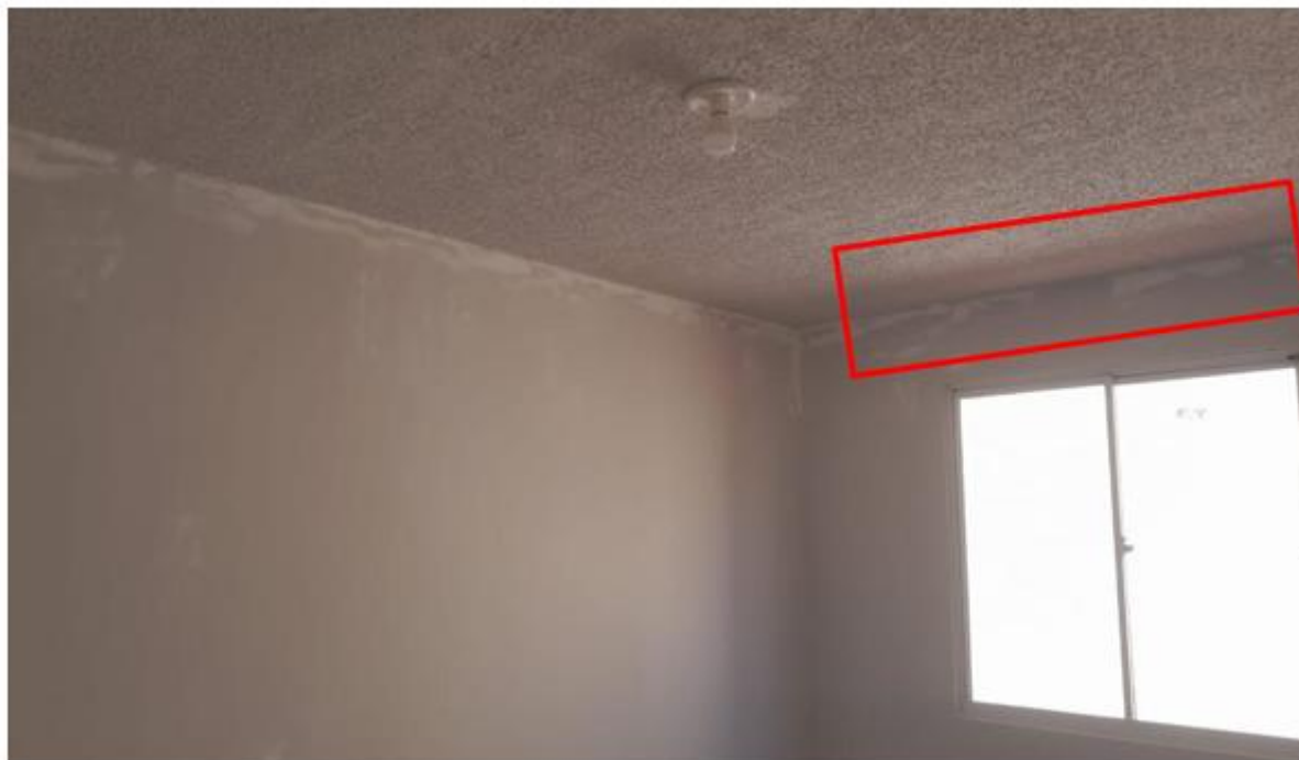
Figura 22 - Acabamentos mal realizados
