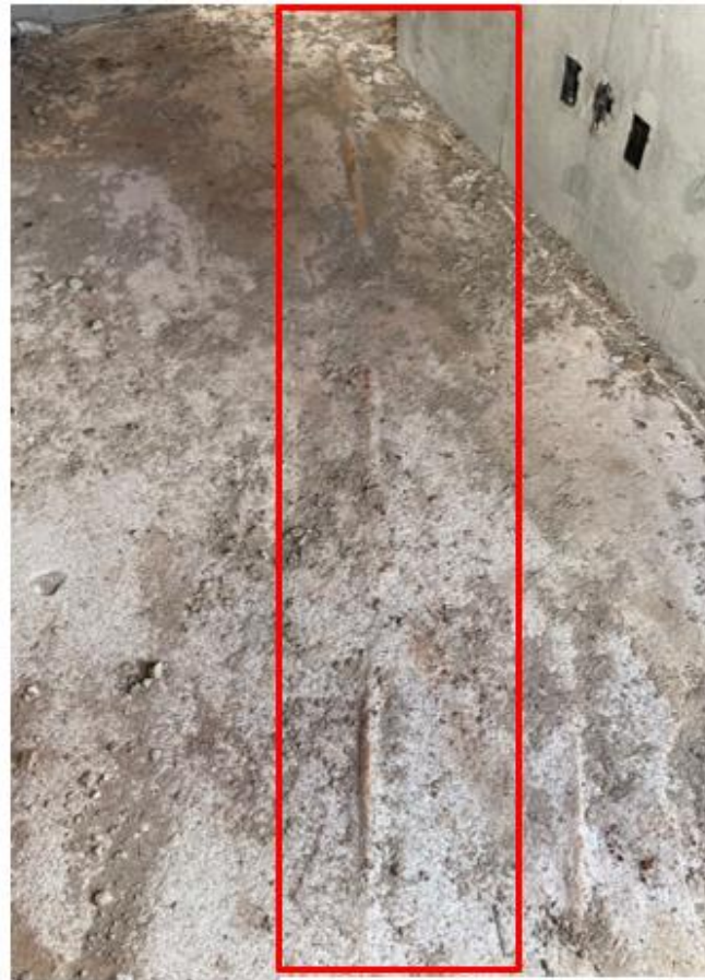
Figura 20 - NC: Mangueira acima do nível do radier
