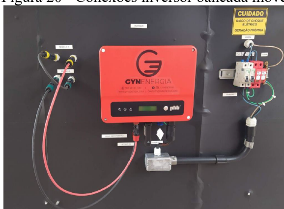
Figura 20 - Conexões inversor bancada móvel
