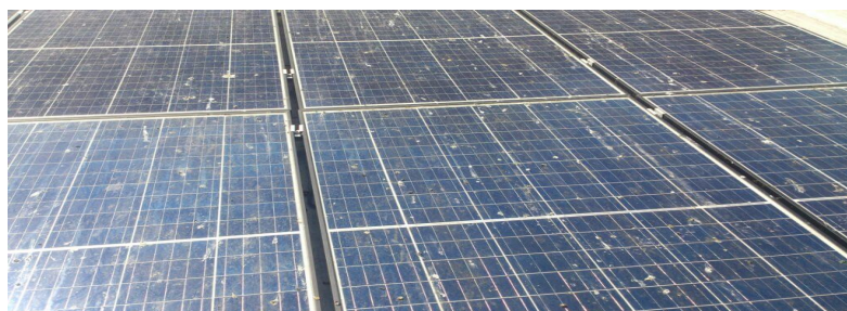
Figura 48 - Módulo fotovoltaico sujo
