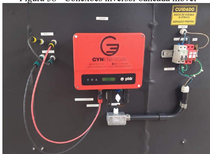
Figura 58 - Conexões inversor bancada móvel
