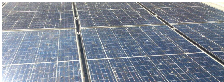
Figura 18 - Módulo fotovoltaico sujo
