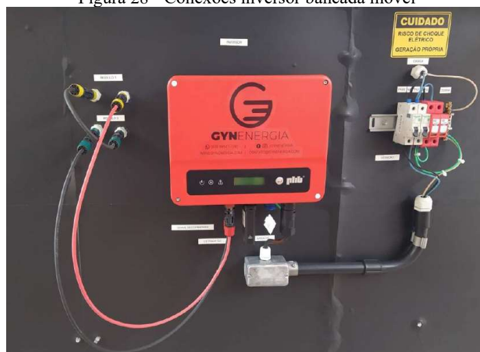
Figura 28 - Conexões inversor bancada móvel
