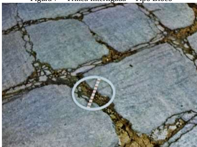
Figura 7 – Trinca Interligada – Tipo Bloco
