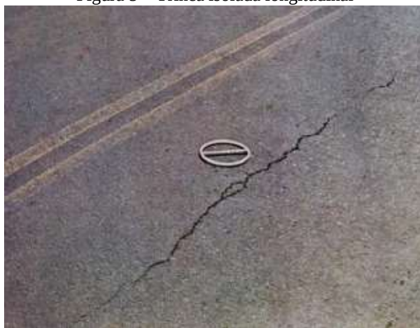
Figura 5 – Trinca isolada longitudinal
