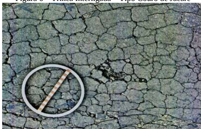
Figura 6 – Trinca Interligada – Tipo Couro de Jacaré
