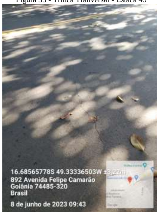
Figura 35 - Trinca Transversal - Estaca 45
