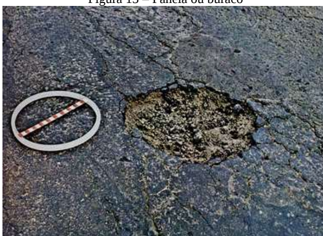
Figura 13 – Panela ou buraco
