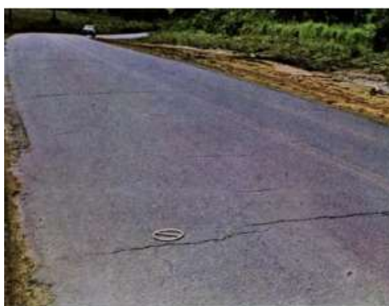
Figura 4 – Trinca isolada transversal
