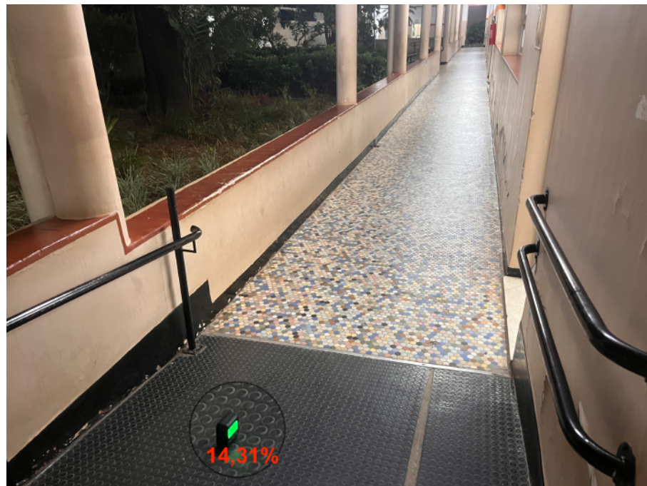
Figura 46: Rampa 03 desnível de 19 cm. Fonte: autora.
