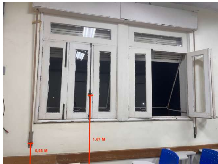
Figura 67: Sala de aula S-208 - Comando de janela. Fonte: autora.
