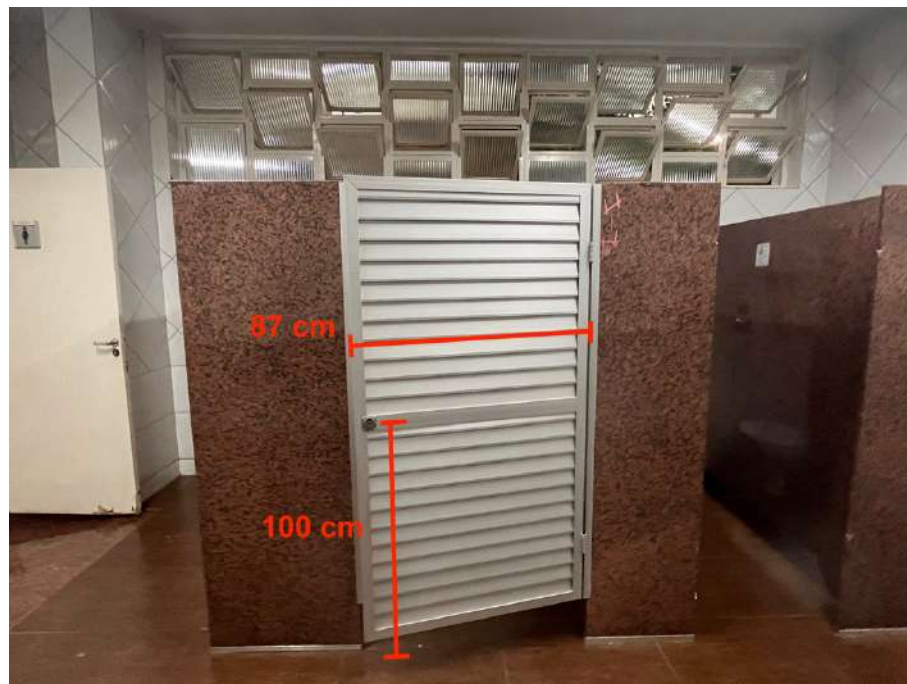
Figura 76: Banheiro feminino térreo – Porta e maçaneta. Fonte: autora.
