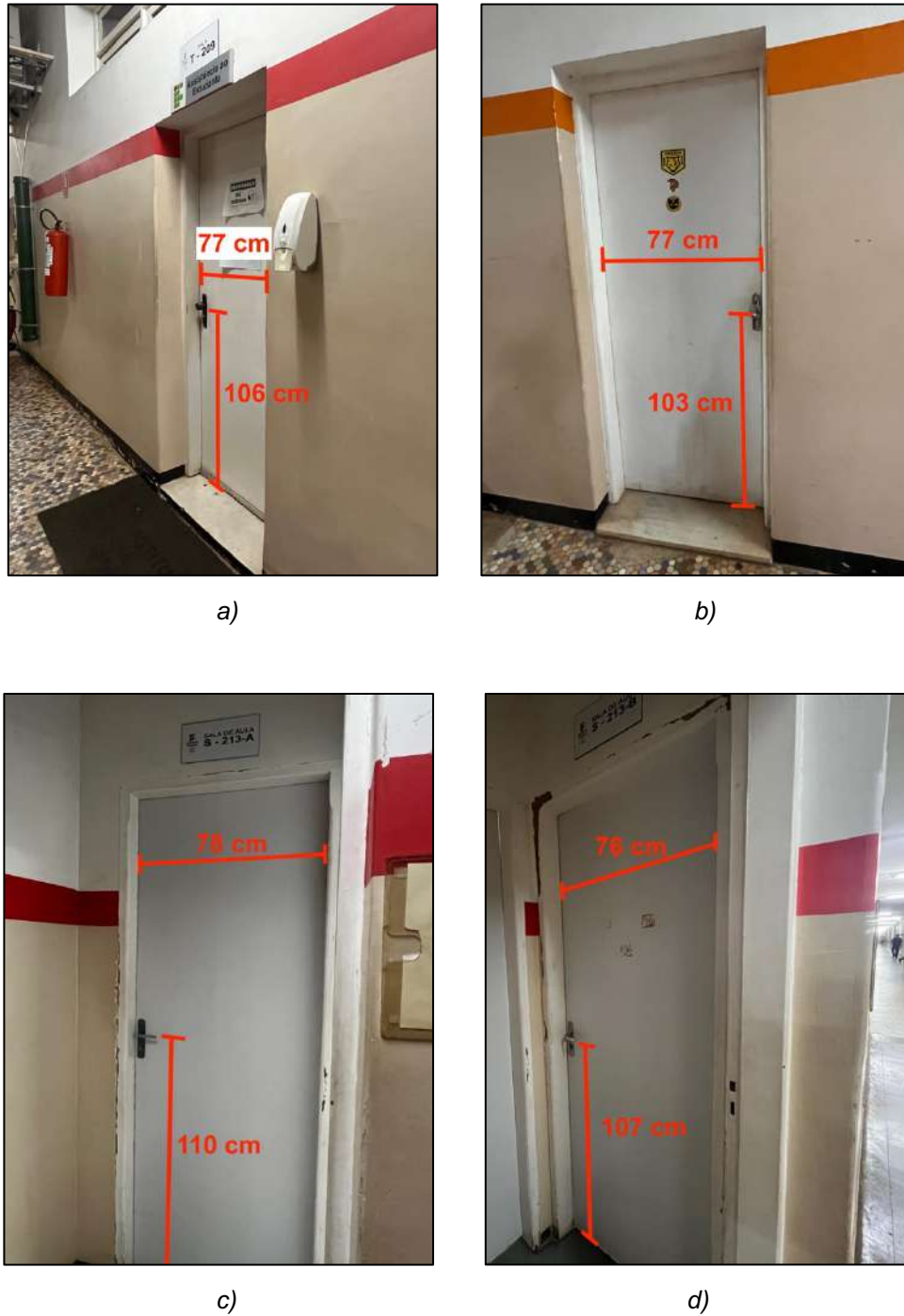
Figura 62: Vão da porta e maçaneta - a) Sala T-209; b) atlética; c) Sala S-213A; d) Sala S-213B.
