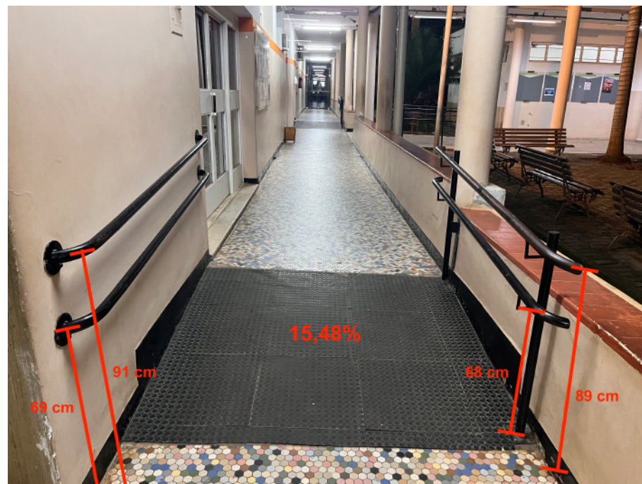
Figura 44: Rampa 02 desnível de 18 cm. Fonte: autora.
