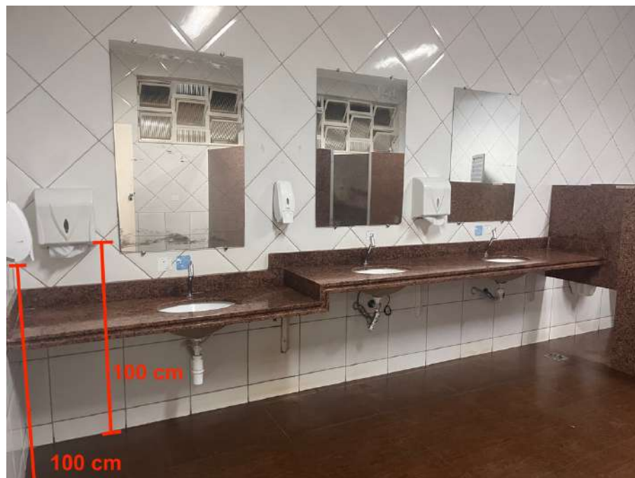
Figura 96: Banheiro masculino superior – Dispenser de papel toalha e sabonete. Fonte: autora.
