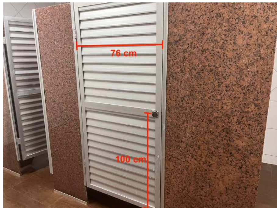
Figura 84: Banheiro feminino térreo – Porta e maçaneta. Fonte: autora.
