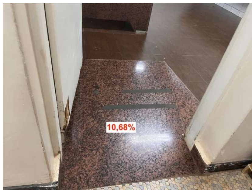
Figura 70: Banheiro feminino térreo – Inclinação rampa, desnível de 13 cm. Fonte: autora.
