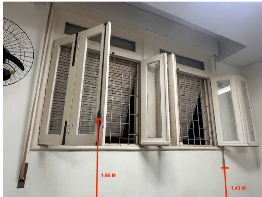
Figura 66: Sala de aula T-205 - Comando de janela. Fonte: autora.
