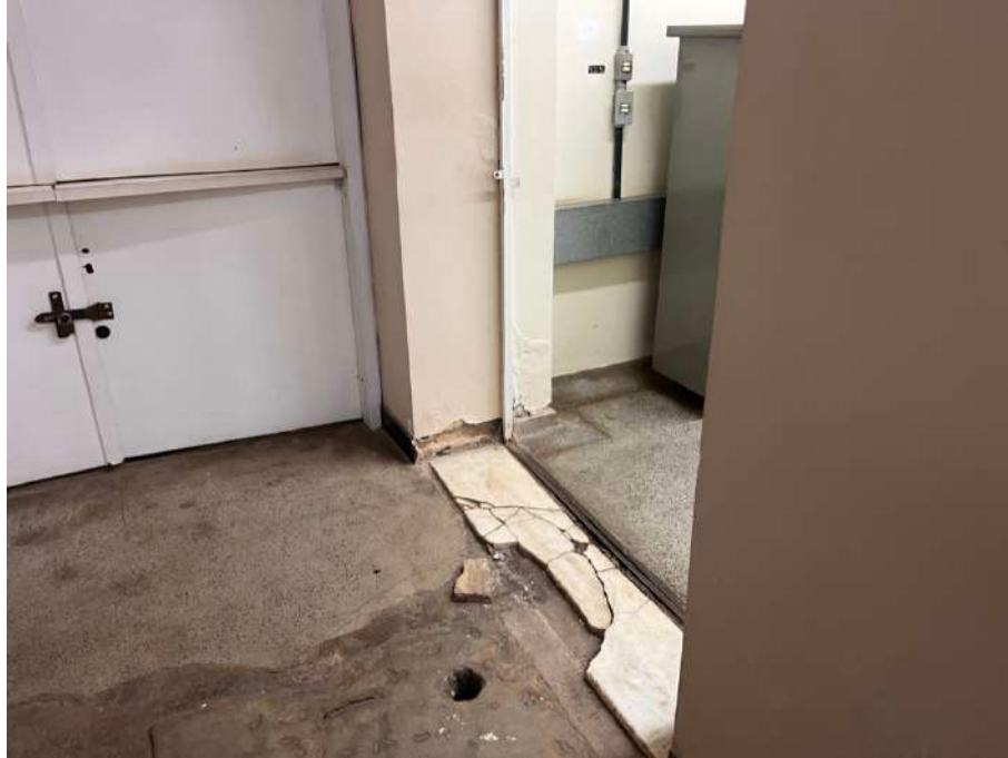
Figura 54: Bloco 200 irregularidade. Fonte: autora.
