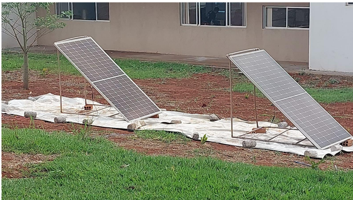
Figura 8 — Painéis fotovoltaicos instalados sobre a estrutura
