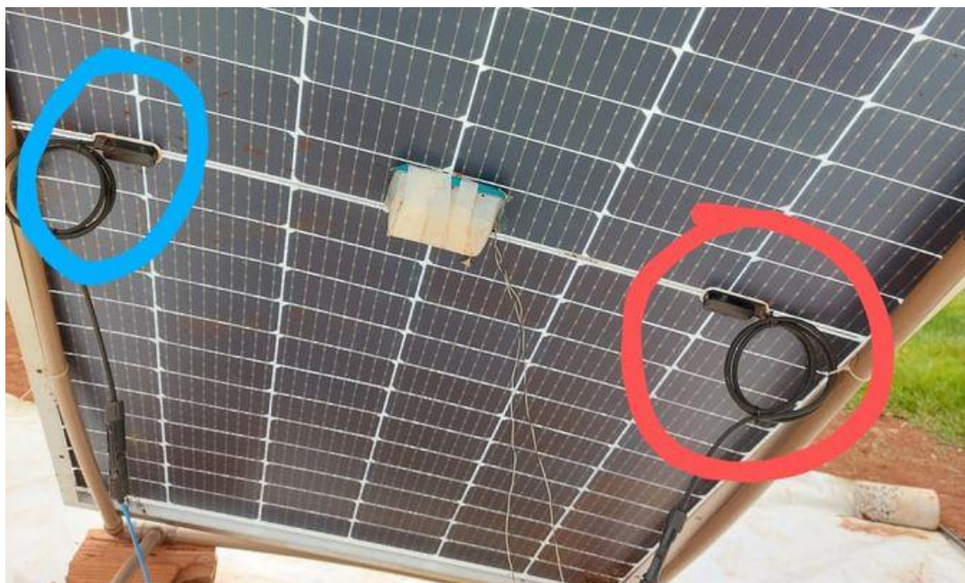
Figura 9 — Conectores (positivo e negativo) do painel fotovoltaico bifacial
