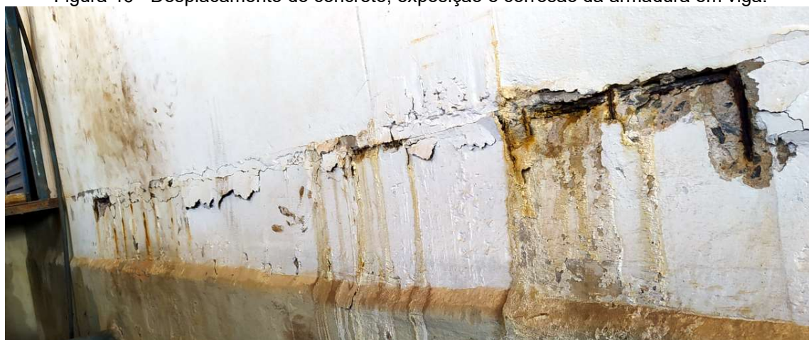
Figura 46 - Deslocamento do concreto, exposição e corrosão da armadura em viga.
