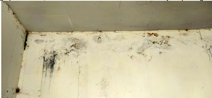
Figura 57 - Viga parede 12B, observa-se a continuidade de manifestações patológicas após pintura.
