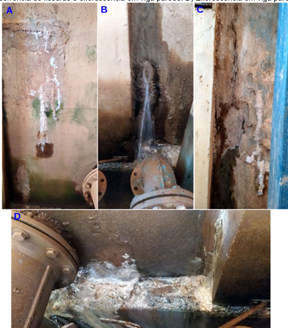
Figura 45 - Manifestações patológicas na viga parede 2 dos filtros. A) Ocorrência de eflorescência em viga parede. B) Ocorrência de fissura e trinca, com vazamento de água na viga parede. C) Ocorrência de fissuras e eflorescência em viga parede. D) Eflorescência em viga parede.
