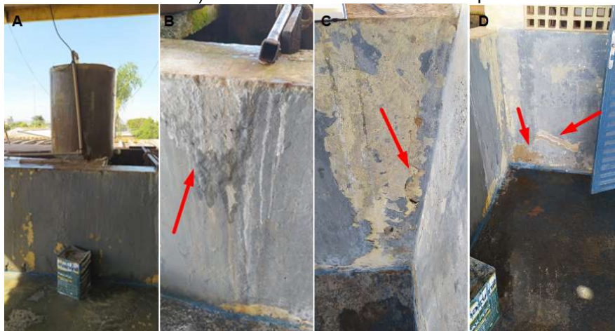
Figura 23 - Parede externa do canal. A) trecho do canal onde foi instalado tanque de coagulante. B) Parede do canal em que se observa empolamento da pintura. C) Parede do canal com deslocamento de concreto. D) Parede lateral do canal com deslocamento de concreto.
