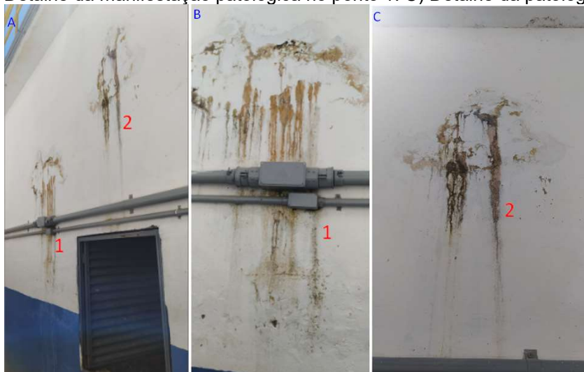
Figura 59 – Continuidade de manifestação patológica na viga parede 13 após pintura. A) Detalhe da continuidade de descolamento, empolamento e sujidade da pintura nos pontos 1 e 2 destacados na figura 58. B) Detalhe da manifestação patológica no ponto 1. C) Detalhe da patologia no ponto 2.
