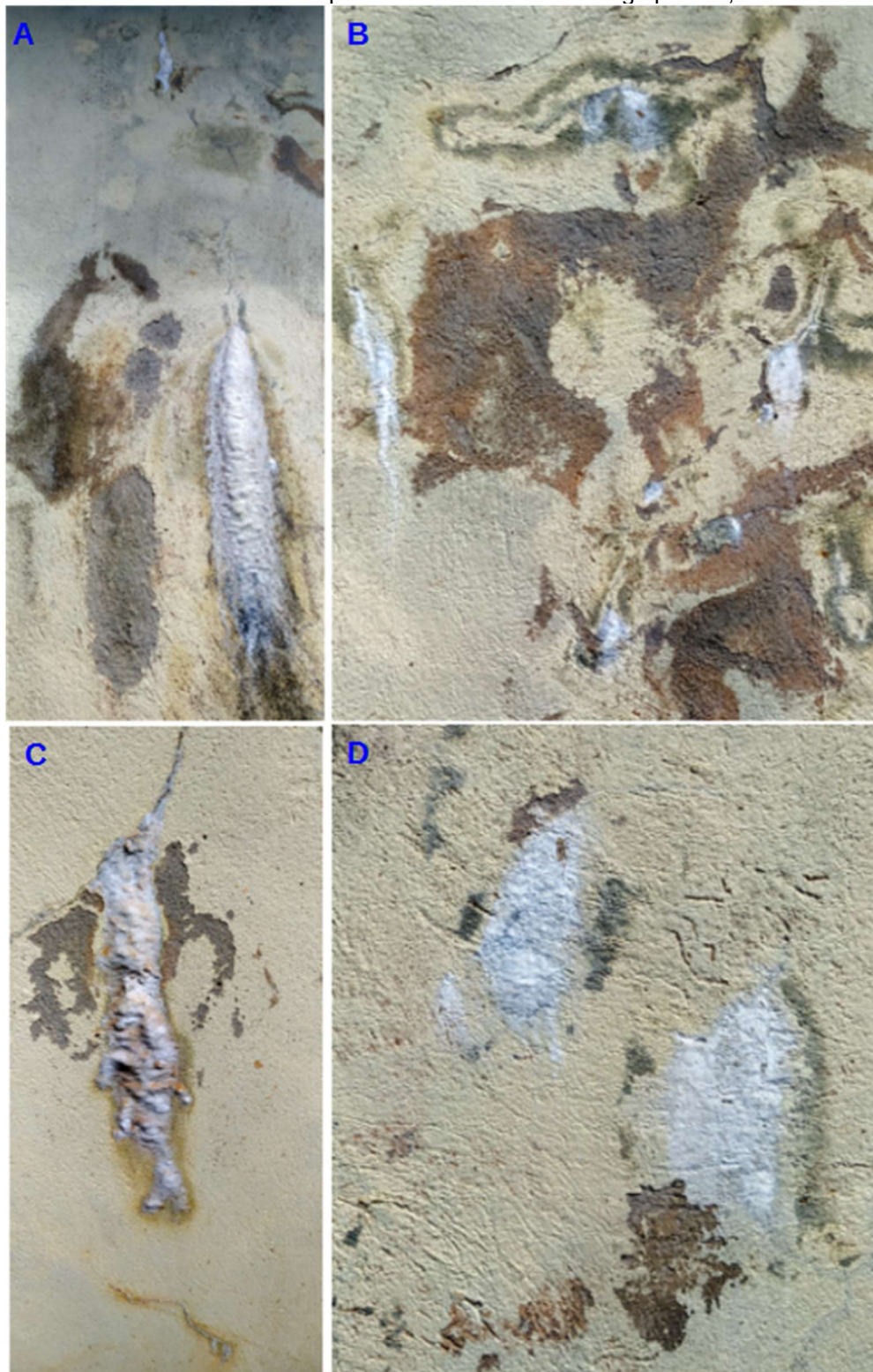
Figura 36 - Ocorrência de eflorescência na viga parede da lateral direita do decantador. A) Destaque para ponto com ocorrência de deslocamento e eflorescência. B) Trecho da viga parede com eflorescência em pontos diversos. C) Detalhe ponto concentrado de eflorescência na viga parede. D) Detalhe de outro ponto de eflorescência na viga parede,
