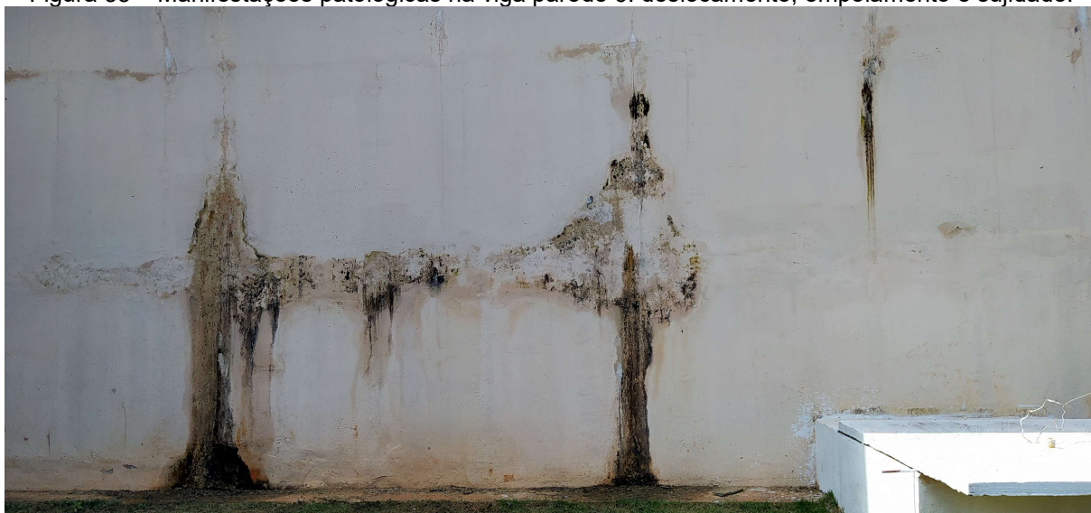
Figura 53 – Manifestações patológicas na viga parede 6: deslocamento, empolamento e sujeira.
