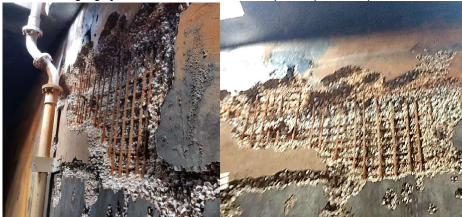
Figura 9 - Desagregação do concreto em um tanque de produto químico de uma ETA
