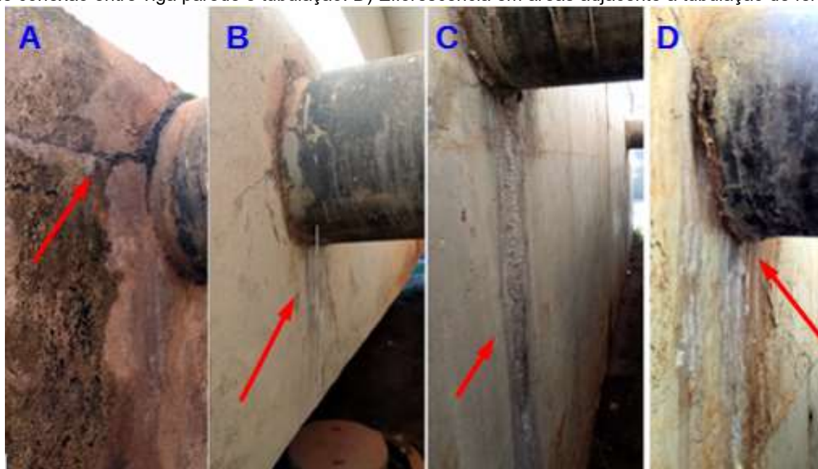
Figura 44 - Manifestações patológicas entre as vigas paredes e as tubulações. A) Fissura no concreto em ponto de conexão com tubulação de ferro fundido. B e C) Ocorrência de eflorescência em trecho de conexão entre viga parede e tubulação. D) Eflorescência em áreas adjacente a tubulação de ferro.
