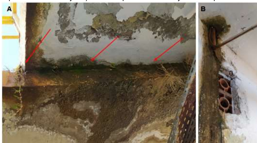
Figura 21 - Vista inferior da laje de sustentação do canal retangular. A) Descolamento e presença de musgo na parte inferior da laje. B) Elevada quantidade de sujeira em parede abaixo da laje.
