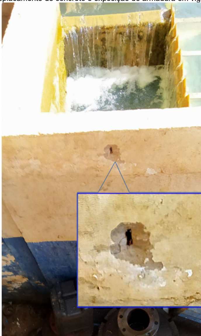
Figura 42 - Deslocamento de concreto e exposição de armadura em viga parede lateral.
