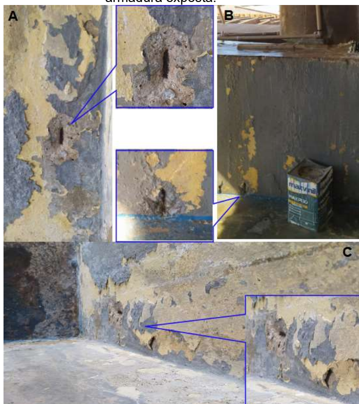
Figura 24 - Parede externa do canal retangular. A) Trecho da parede com descolamento da pintura, deslocamento do concreto e exposição da armadura. B) Trecho onde da parede do canal com armadura exposta.
