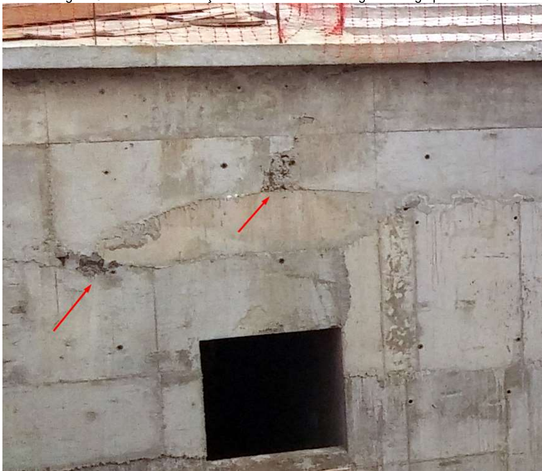
Figura 62 - Possível formação de ninhos de concretagem na viga parede 13.
