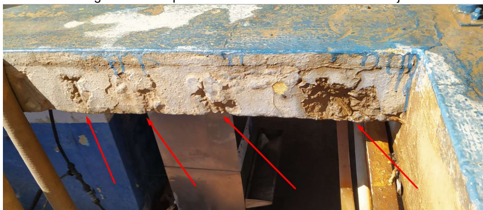
Figura 22 - Deslocamento de concreto na borda da laje
