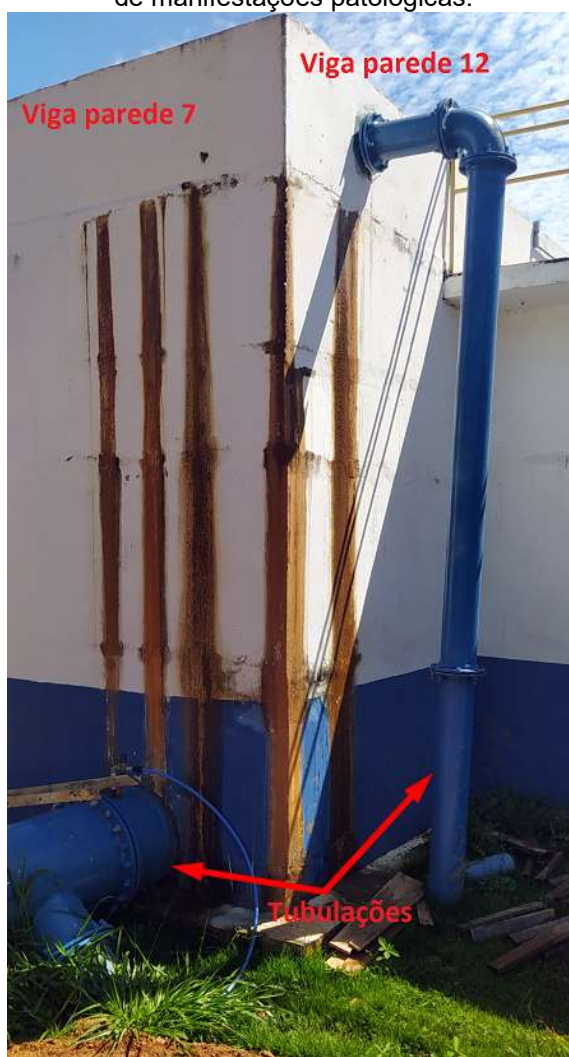
Figura 50 - Viga parede 7 e 12, onde observa-se a chega de tubulação de água bruta e a ocorrência de manifestações patológicas.
