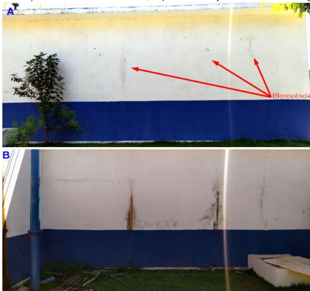
Figura 55 - Manifestações patológicas na viga parede 6. A) Continuidade de eflorescência destacados na figura 54. B) Continuidade de descolamento, empolamento e sujidade referenciados na figura 53.
