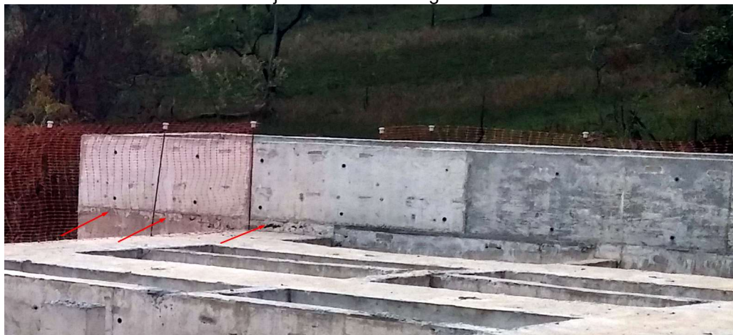
Figura 61 - - Viga parede 12 após conclusão da concretagem, onde é possível observar falhas nas juntas de concretagem.
