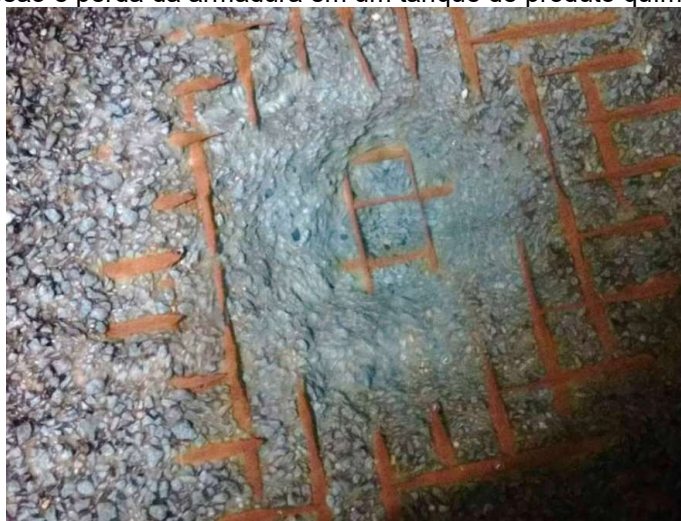
Figura 10 - Erosão e perda da armadura em um tanque de produto químico de uma ETA
