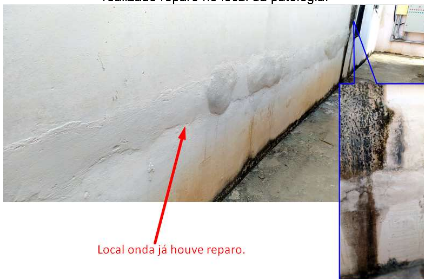
Figura 58 - Manifestações patológicas na viga parede 13, onde é possível observar que já foi realizado reparo no local da patologia.
