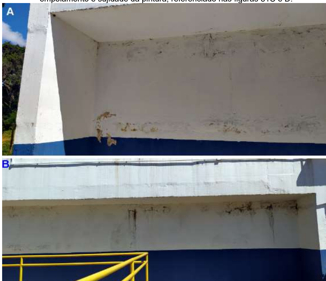
Figura 52 – Manifestações patológicas na viga parede 19 após a realização de reparos. A) Continuidade de descolamento e empolamento referenciado na figura 51. B) Descolamento, empolamento e sujidade da pintura, referenciado nas figuras 51C e D.
