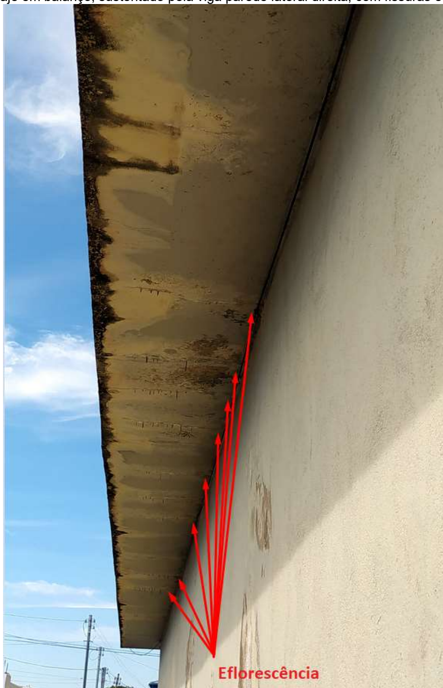
Figura 38 - Laje em balanço, sustentado pela viga parede lateral direita, com fissuras e eflorescência.
