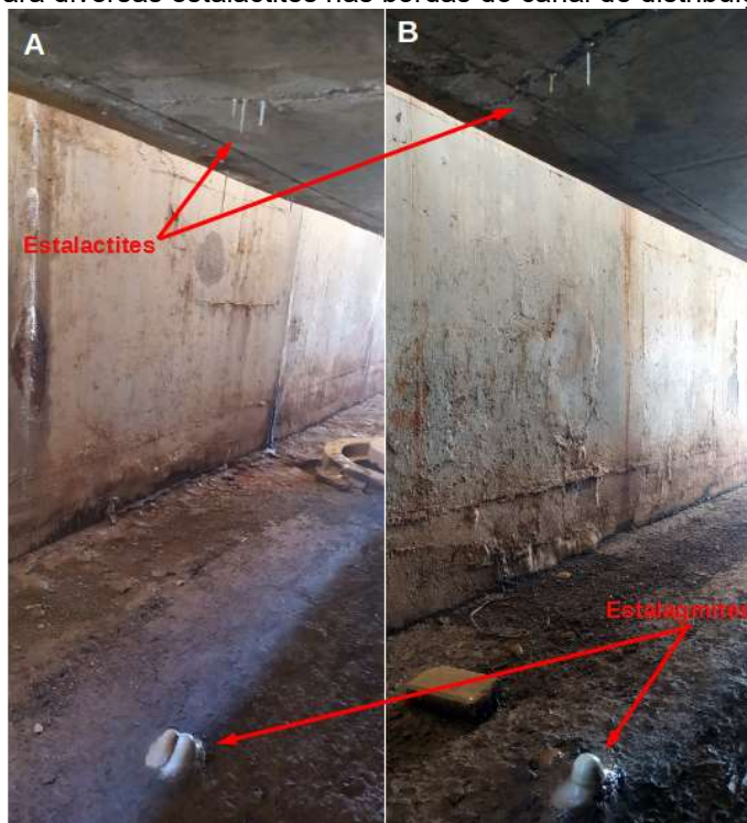
Figura 33 - Ocorrência de eflorescência no fundo do canal. A) Observa-se a ocorrência de estalactites e estalagmites abaixo de uma das fissuras. B) Destaque para estalactites e estalagmites no canal. C) Destaque para diversas estalactites nas bordas do canal de distribuição de água.
