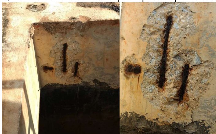
Figura 8 - Corrosão de armadura em tanque de produto químico em uma ETA.
