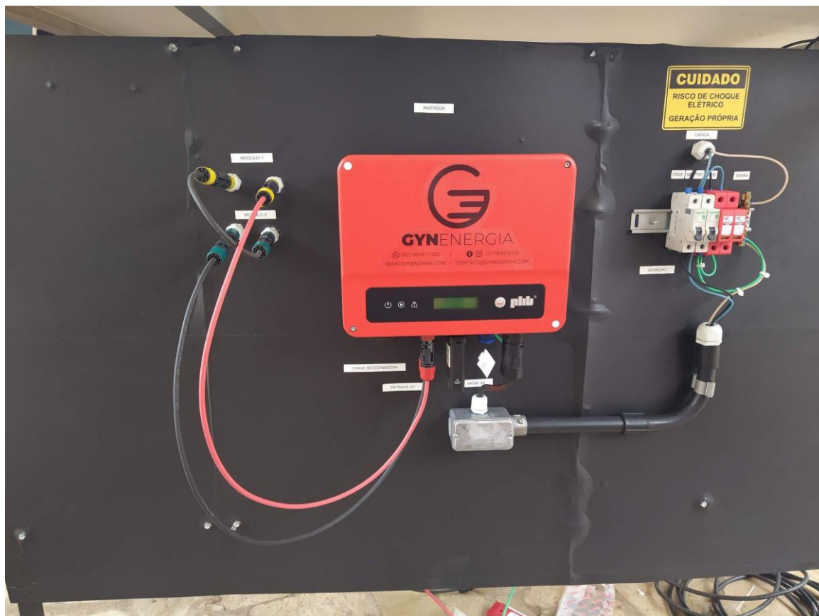
Figura 39 - Inversor e quadro de proteções.
