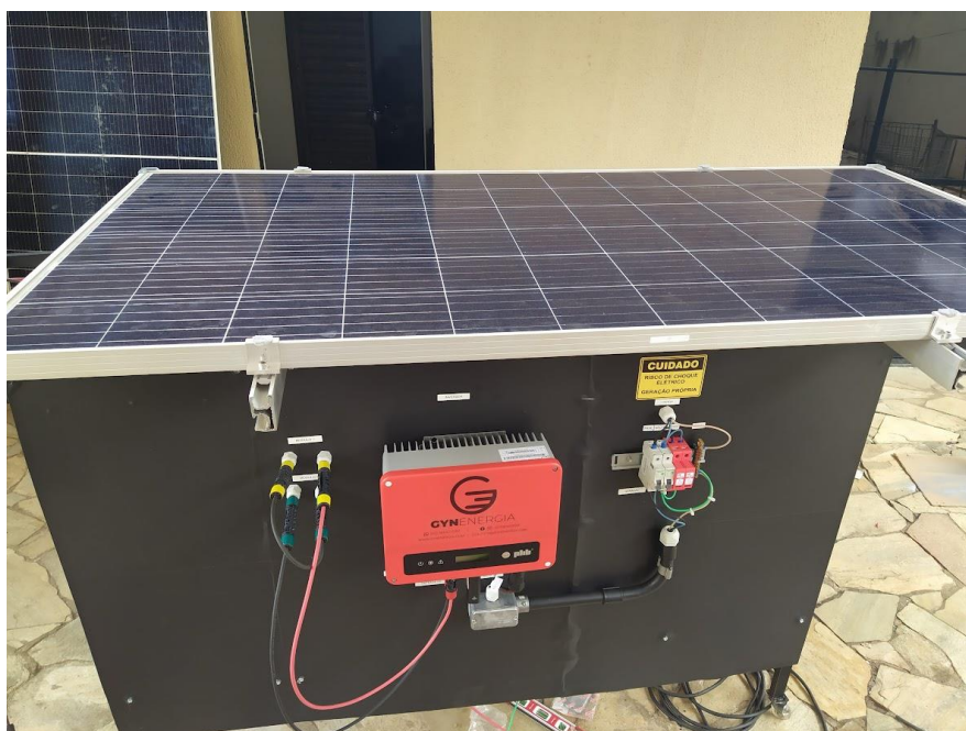
Figura 30 - Bancada Didática de Energia Solar Fotovoltaica.
