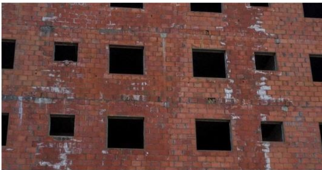
Figura 27 – Eflorescência em alvenarias expostas
