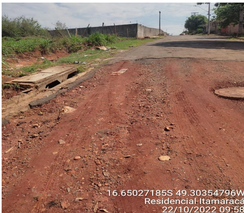
Figura 18. Boca de lobo Rua RIT 1, Residencial Itamaracá.
