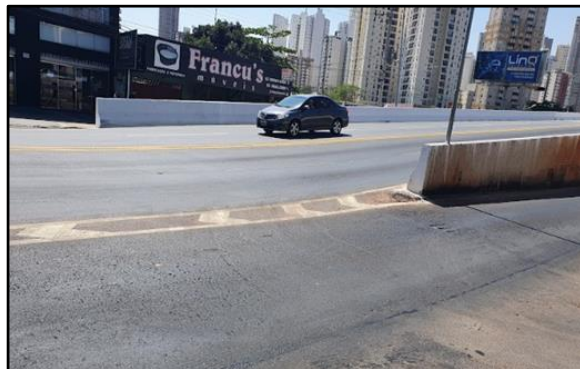
Figura 27 – Barreira “ New Jersey ” sem sinalização e proteção.
