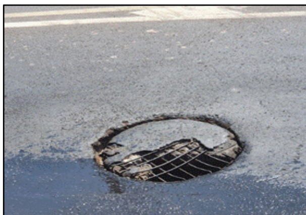
Figura 29 - Poço de visita inseguro.
