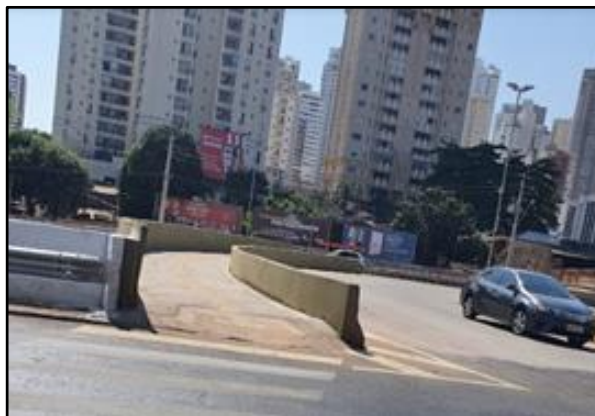
Figura 36 - Barreira "New Jersey" para proteção do pedestre
