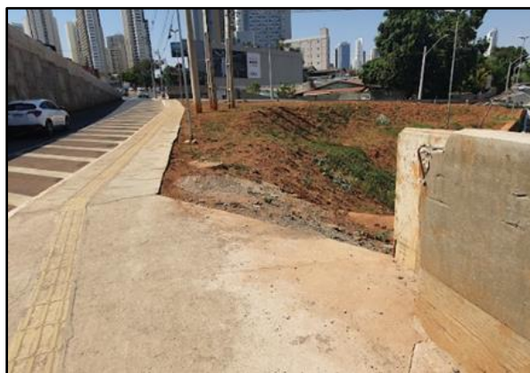
Figura 41 - Passagem de pedestres sem proteção.
