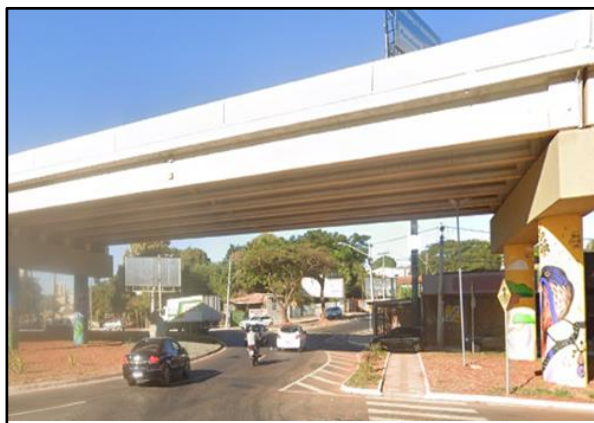
Figura 32 - Ausência de sinalização regulamentadora de altura máxima permitida.
