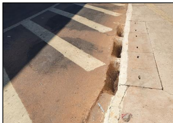
Figura 43 - Bueiros sem grade.
