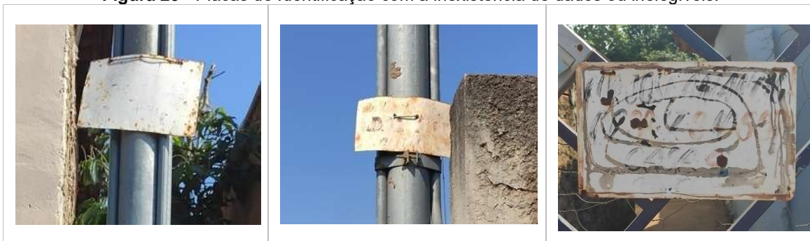
Figura 29 - Placas de Identificação com a inexistência de dados ou ilegíveis.
