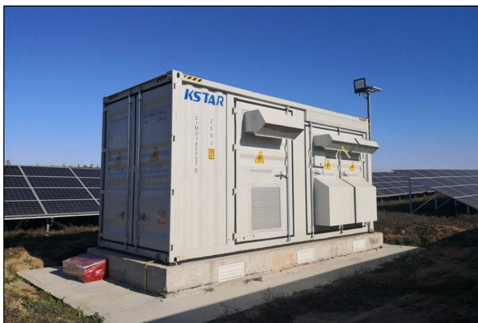
Figura 34: Inversor centralizado de 6,25MW da Kstar.
