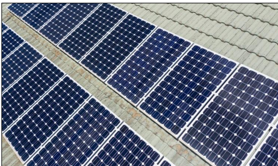
Figura 64: Módulos fotovoltaicos em telha tégula.
