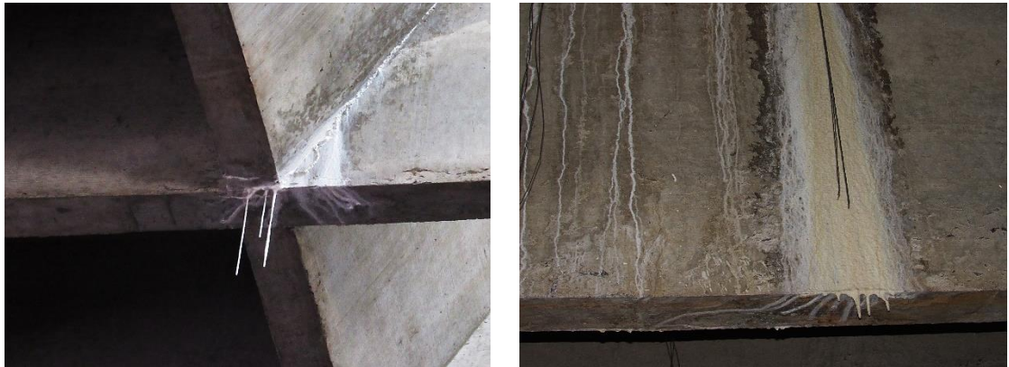
Figura 38 – Formação de estalactite na cobertura em concreto do clube.
