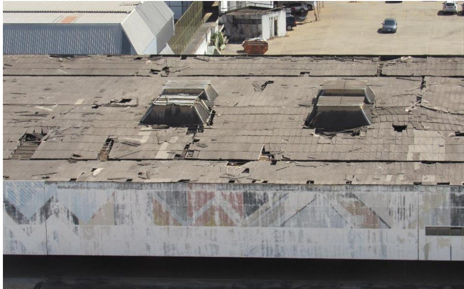
Figura 32 – Telhas danificadas da cobertura do clube.
