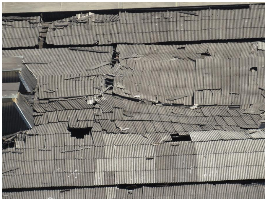
Figura 33 - Deslocamento e falta de reposição de telhas na cobertura.
