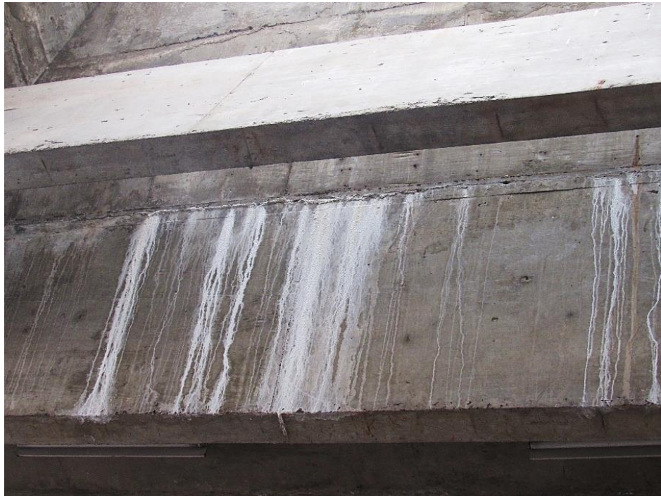
Figura 36 – Eflorescência na região da claraboia.
