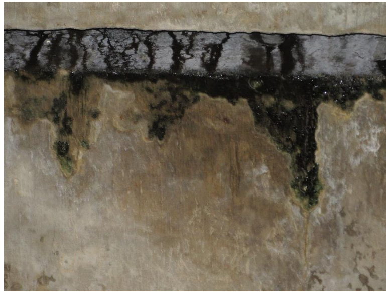
Figura 17 – Manchas escuras encontrada na estrutura inferior da cobertura do JCG.
