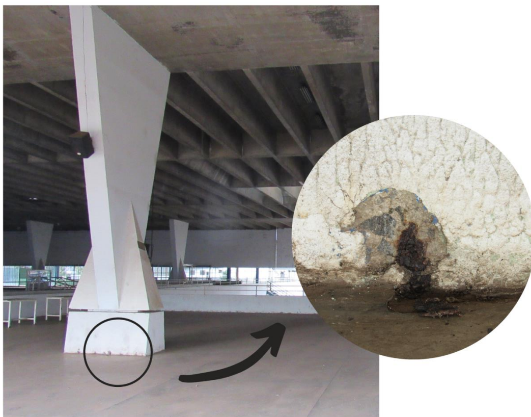
Figura 46 – Corrosão da armadura do Pilar 5 no 2º pavimento do clube.
