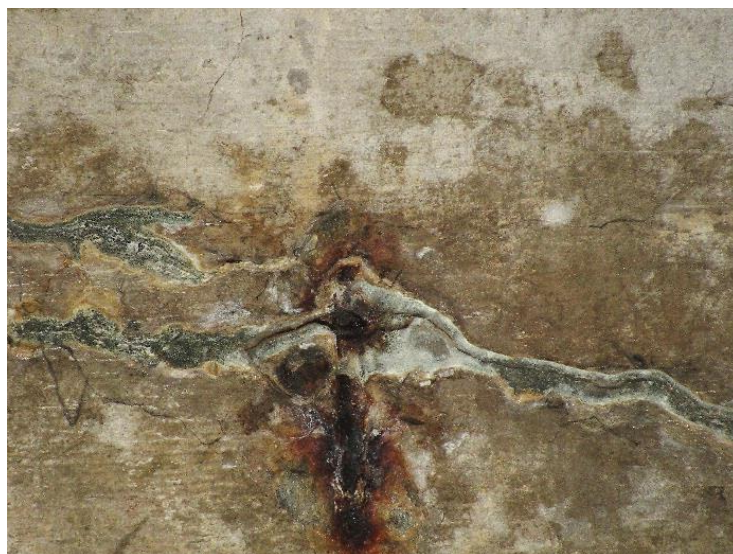
Figura 12 – Corrosão presente na armadura da estrutura inferior da cobertura do JCG.
