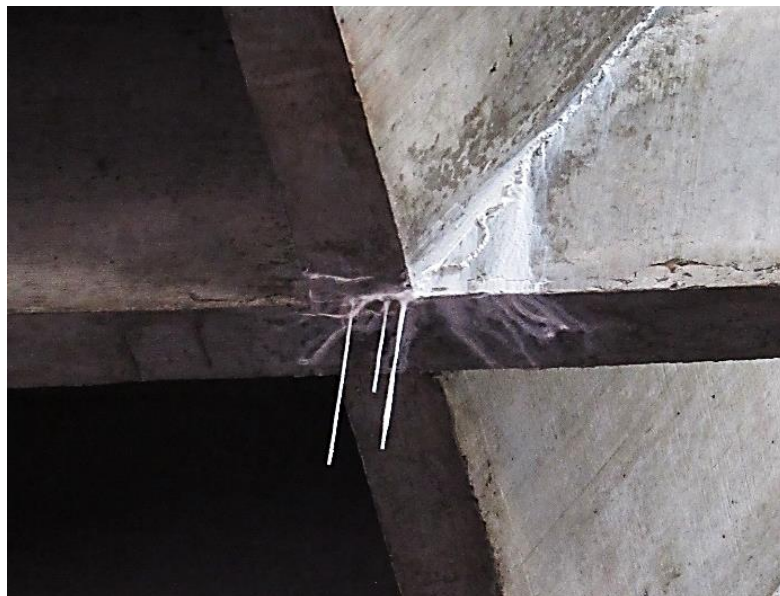
Figura 16 – Estalactite encontrada na estrutura inferior da cobertura do JCG.
