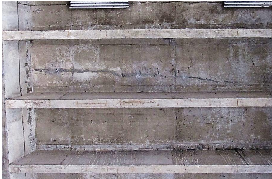
Figura 29 – Fissura na laje da cobertura do clube.
