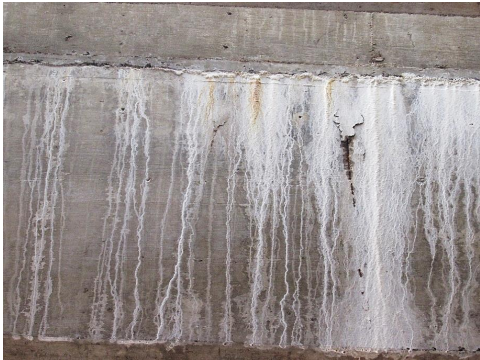
Figura 37 – Eflorescência e corrosão das armaduras na região da claraboia.
