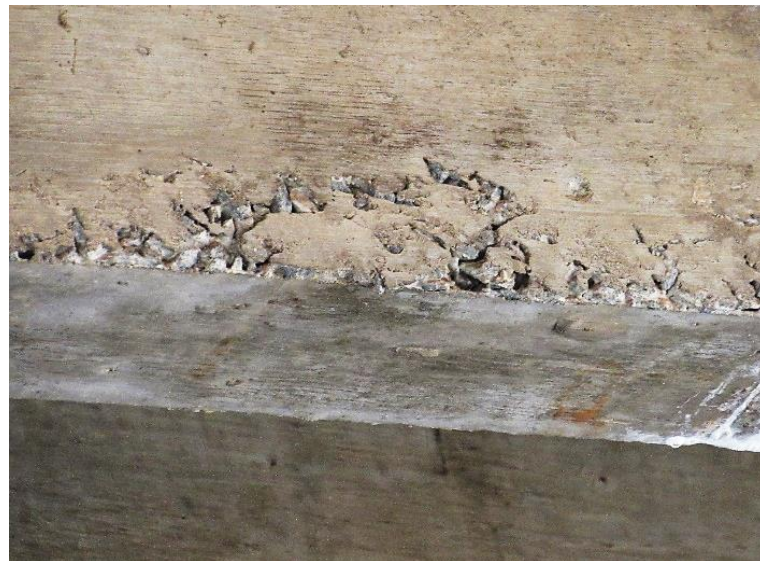
Figura 14 – Separação dos agregados do concreto, configurando a segregação do material.
