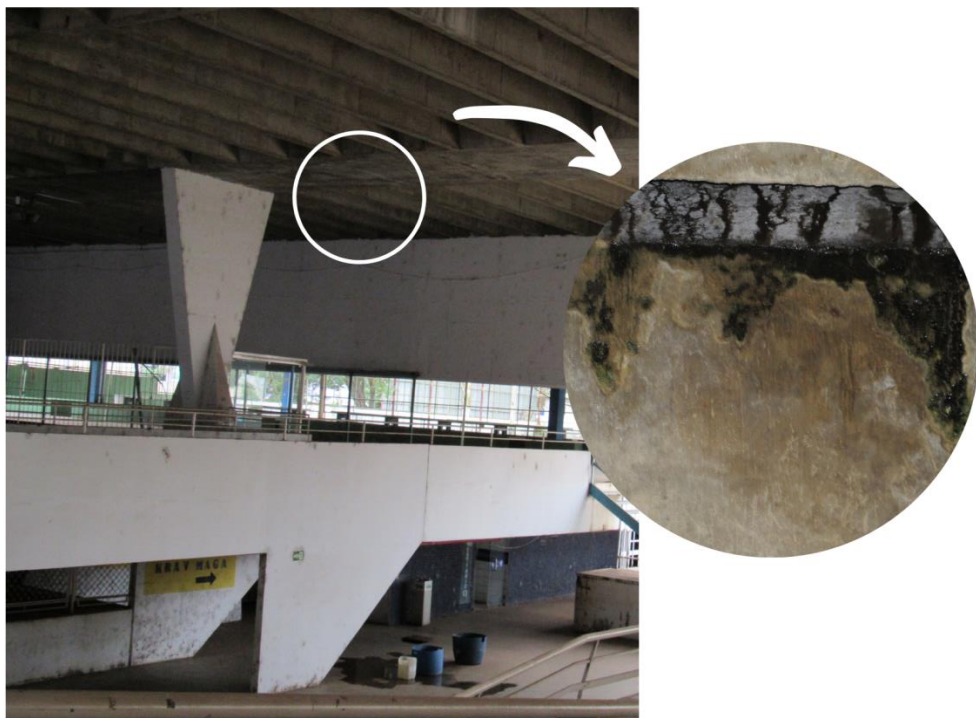
Figura 45 – Infiltração e presença de fungos na cobertura.
