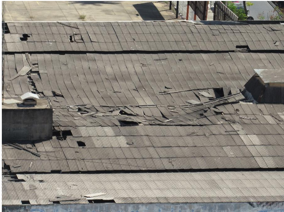
Figura 40 - Deslocamento e falta de reposição de telhas na cobertura.
