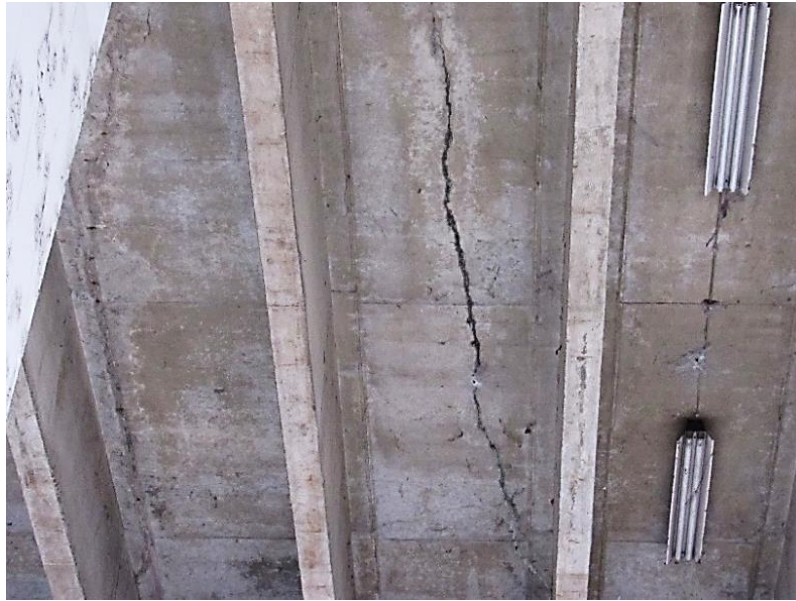
Figura 30 – Fissura na laje da cobertura do clube.
