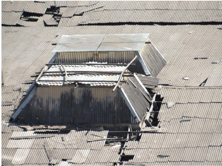
Figura 42 – Substituição improvisada das peças da claraboia 2.
