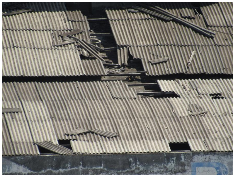
Figura 39 - Deslocamento das telhas na cobertura.
