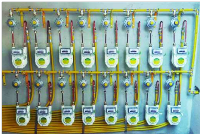
Figura 8 – Central de medição de gás – Tubo multicamada PEX, cobre flexível e conexões
