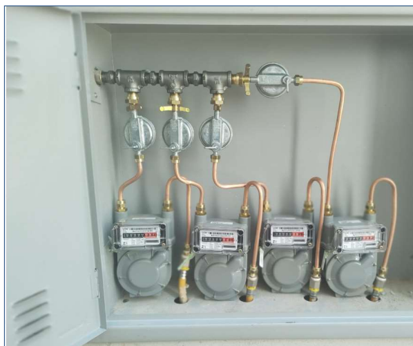
Figura 12 – Abrigo – Tubo multicamada PEX, tubo de cobre flexível e Conexões Aço Carbono
