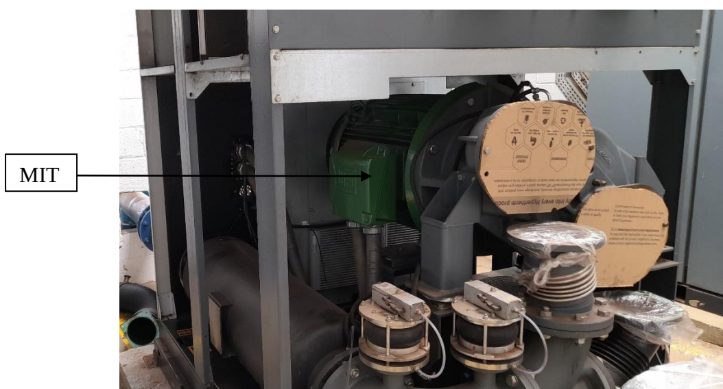
Figura 6.2 – Soprador de ar 04 SB8623 Cargill agrícola (CARGILL, 2021).
