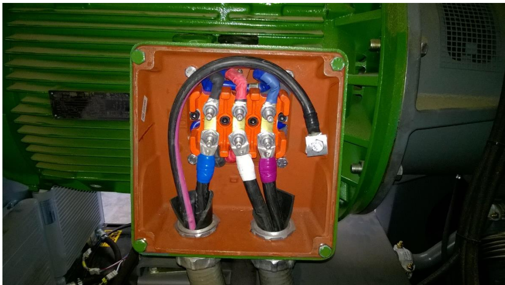
Figura 6.7 – Caixa de ligação MIT SB8623 (CARGILL, 2021)
