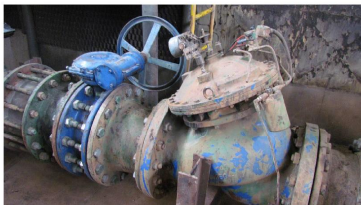
Figura 16 – Tubulação de recalque do Booster Rio Verde
