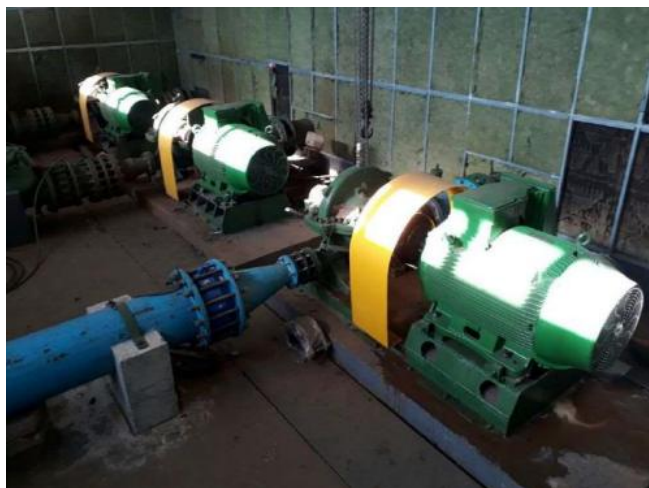
Figura 20 – Booster com inversores de frequência
