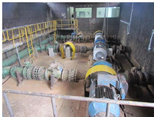
Figura 15 – Motores Booster Rio Verde
