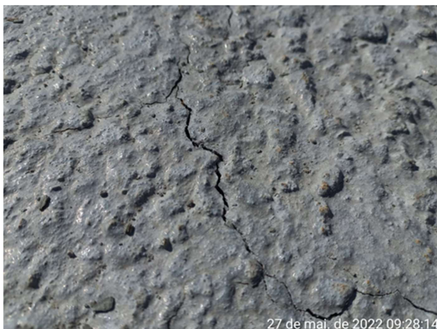
Figura 2 - Fissuras devido a retração do concreto
