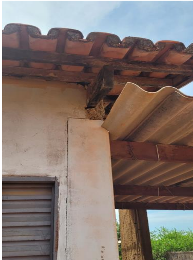
Figura 3- fissura vertical entre alvenaria e pilar Fonte: Próprio autor, 2022
