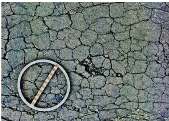
Figura 14 - Trinca tipo “Couro de Jacaré”
