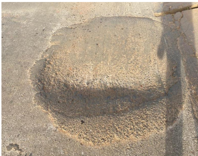
Figura 32- Afundamento de consolidação
