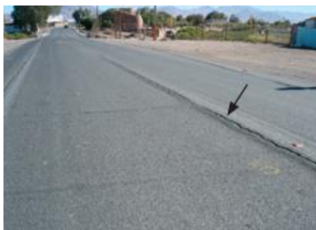
Figura 13 - Trinca de Retração
