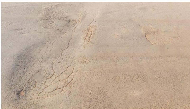
Figura 33- Afundamento de consolidação com trincas
