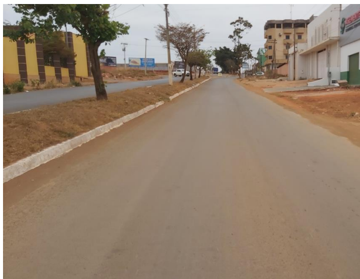
Figura 3- Pavimento da cidade de Formosa
