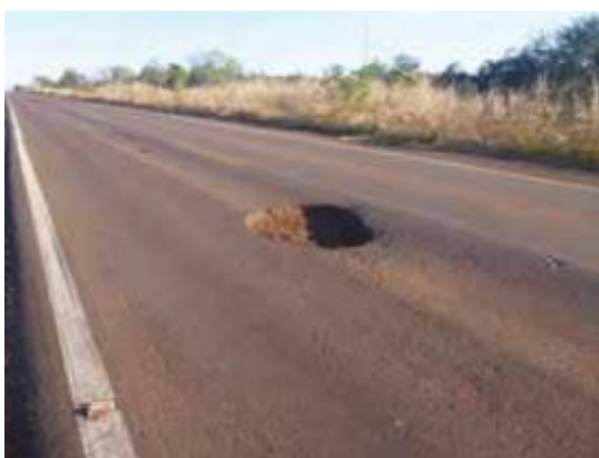
Figura 22 - Panela ou buraco
