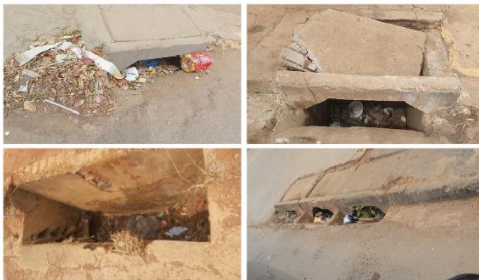
Figura 45- Bocas de lobos com resíduos sólidos
