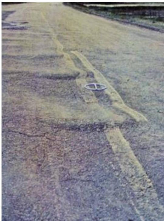
Figura 18 - Ondulação ou Corrugação
