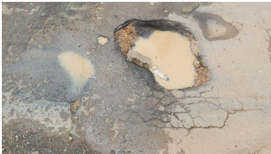
Figura 47- Buraco com presença de água - Trecho 01
