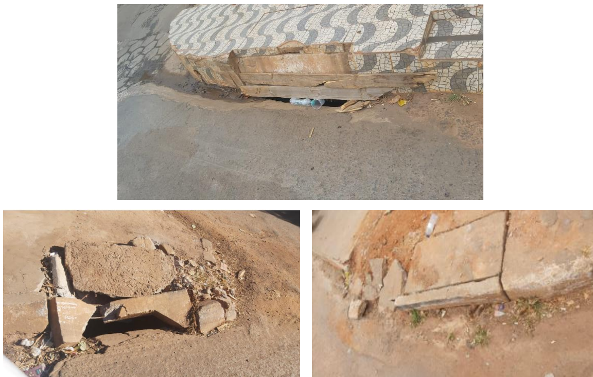
Figura 44- Bocas de lobos deterioradas
