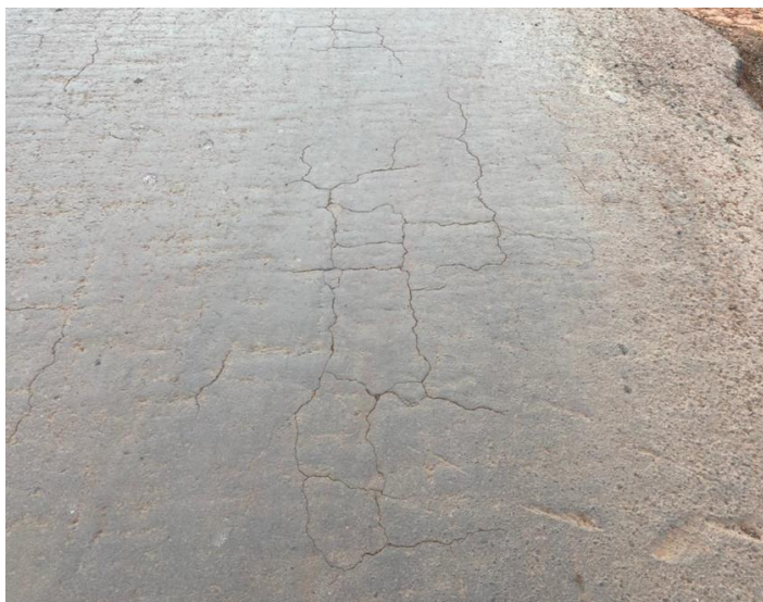
Figura 30- Trinca tipo Bloco
