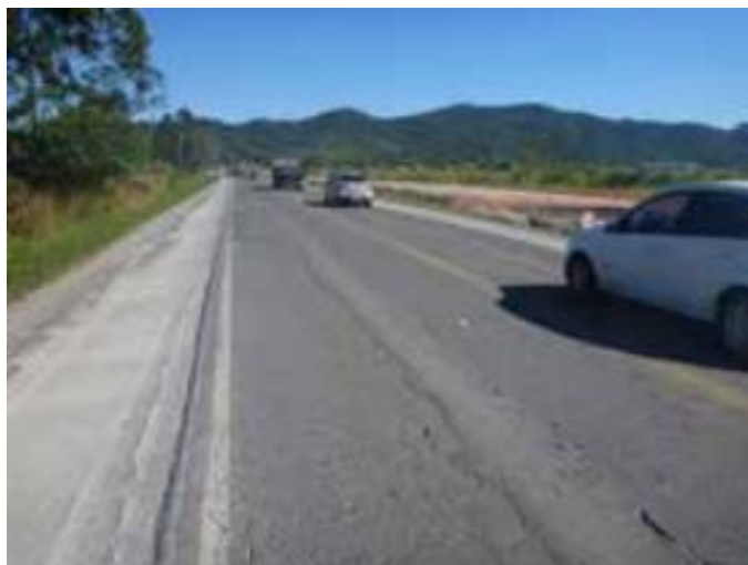
Figura 17 - Afundamento de Consolidação
