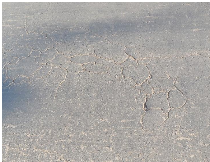
Figura 31- Trinca tipo “Couro de Jacaré”
