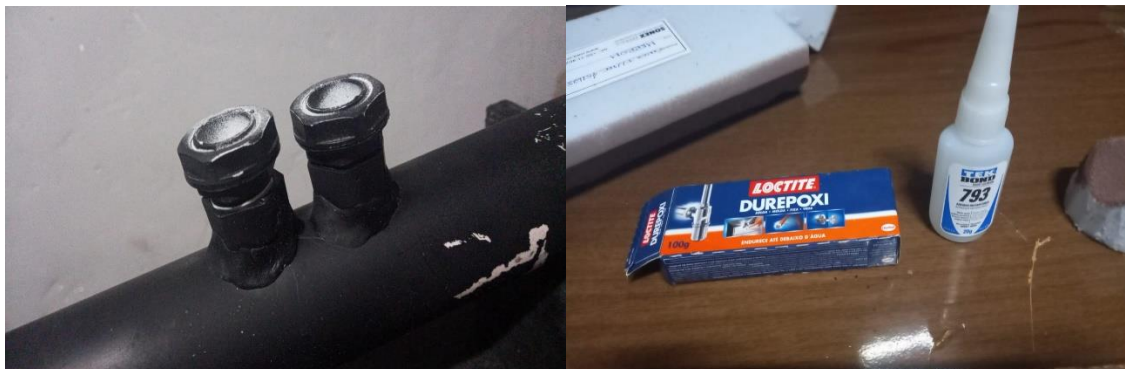
Figura 29 - Prensa cabos fixado
