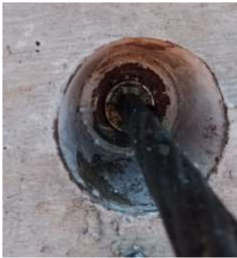
FIGURA 22 – Cunhas dos cabos de protensão.
