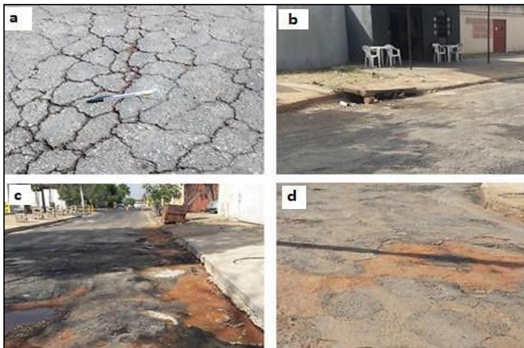
Figura 2 - Trincas (a), corrugação (b), buracos (panelas) (c) e desprendimento de capa (d), respectivamente
