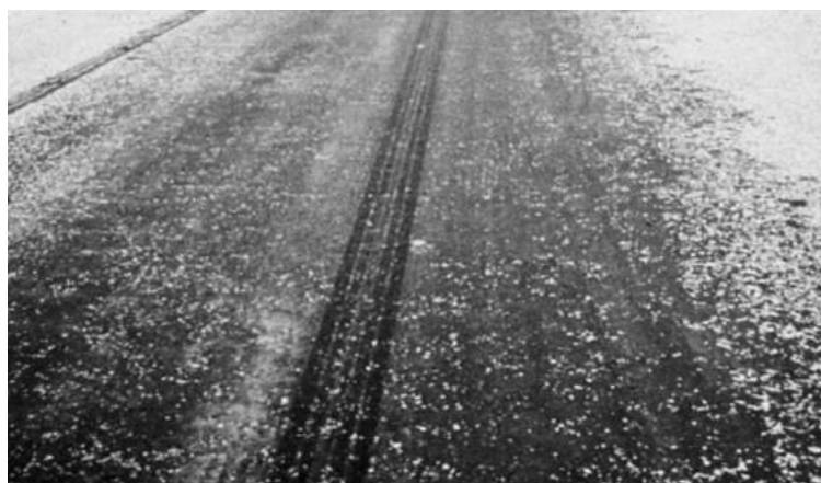
Figura 19 – Exsudação do material betuminoso em pavimento asfáltico.
