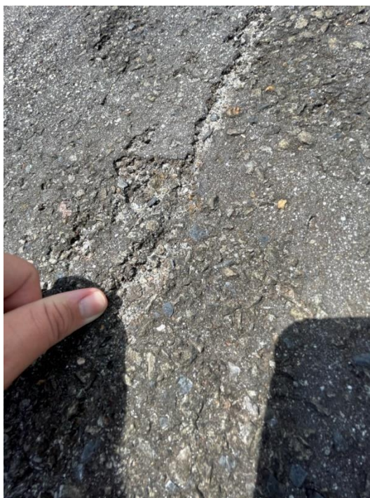
Figura 38 – Trinca longitudinal na PPD
