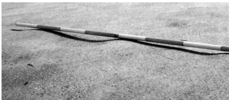
Figura 21 – Afundamento plástico alto nas trilhas de roda de pavimento asfáltico
