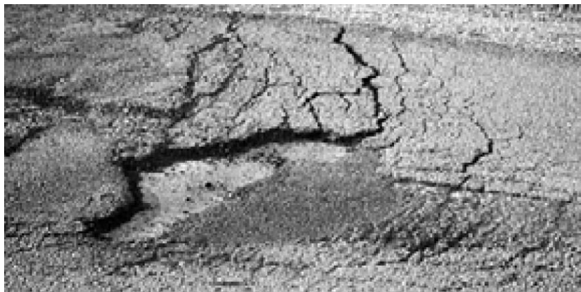
Figura 33 – Descolamento pontual intenso
