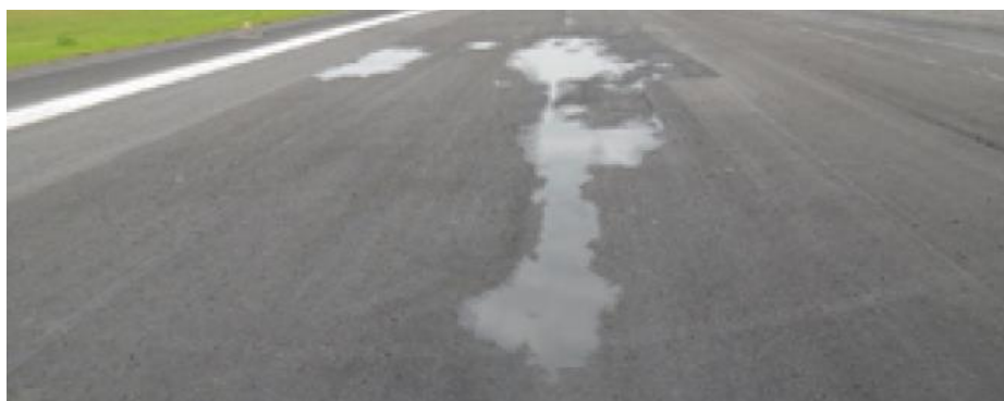
Figura 32 – Empoçamento médio de água na PPD
