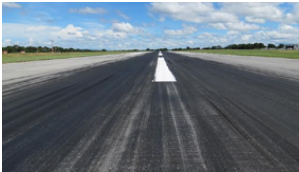
Figura 34 – Acúmulo de borracha em pavimento de pista de pouso e decolagem
