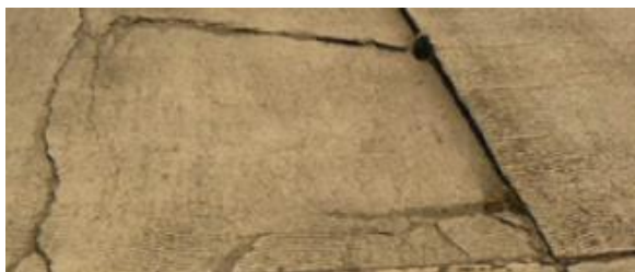
Figura 27 – Juntas não seladas e trincas em pavimento de concreto (pátio)
