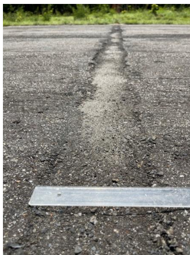
Figura 42 – Afundamento pontual na cabeceira 20
