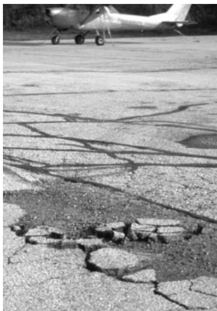
Figura 29 – Formação de grande buraco com desprendimento de material asfáltico
