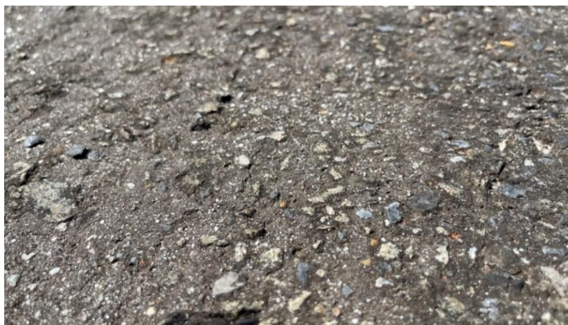
Figura 48 – Desagregação superficial na PPD
