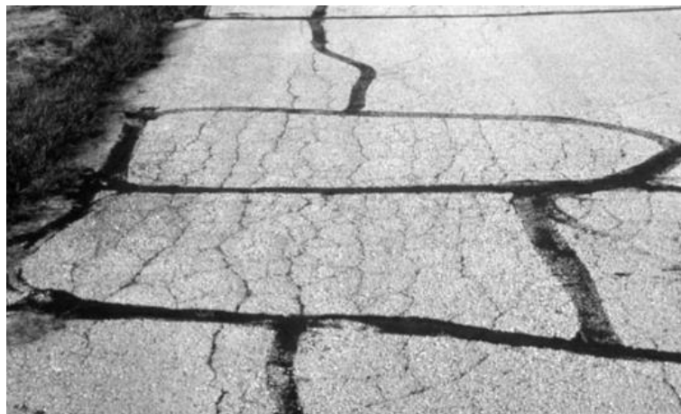
Figura 24 – Trincas do tipo couro de jacaré de intensidade média
