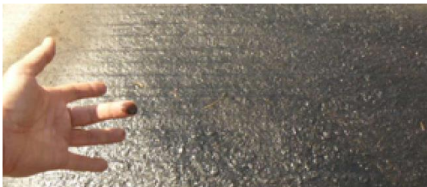
Figura 36 – Acúmulo alto de óleo / combustível em pátio
