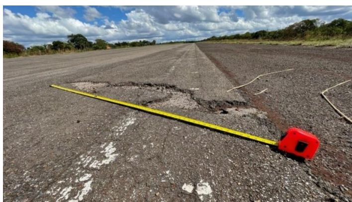
Figura 44 – Buraco próximo ao acostamento da PPD
