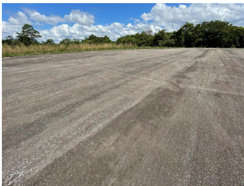
Figura 40 – Acúmulo visual de borracha na cabeceira 20
