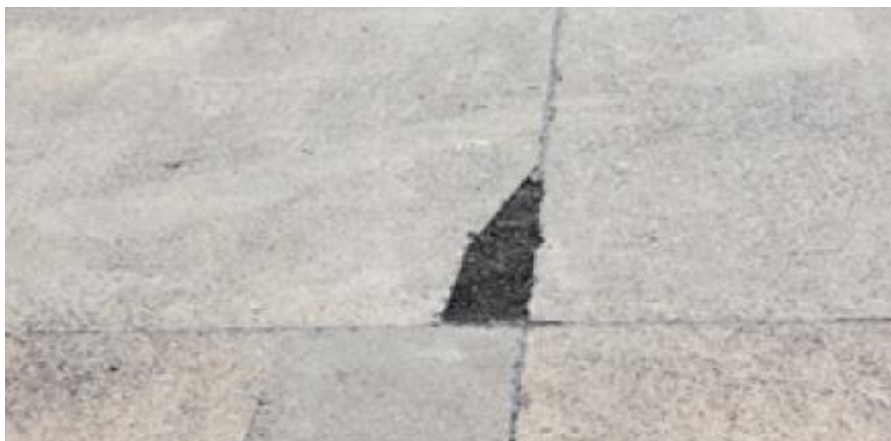
Figura 28 – Esborcinamento em placa de concreto
