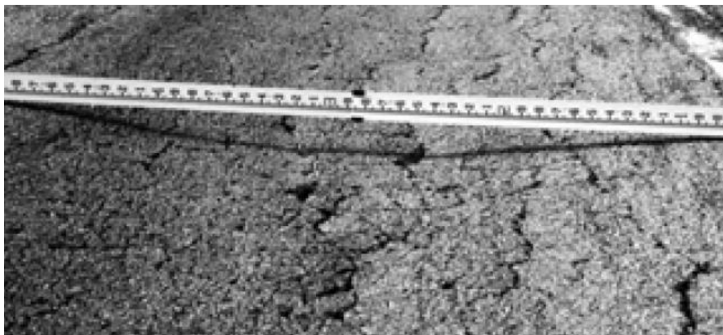
Figura 22 – Afundamento pontual de intensidade alta em pavimento asfáltico
