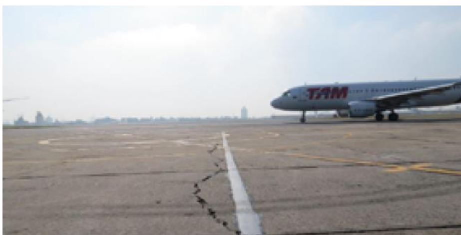
Figura 26 – Trincas em pavimento rígido localizadas em pátios de estacionamento de aeronaves.
