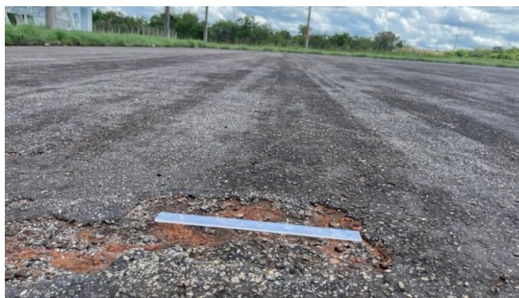
Figura 46 – Buraco no pátio das aeronaves
