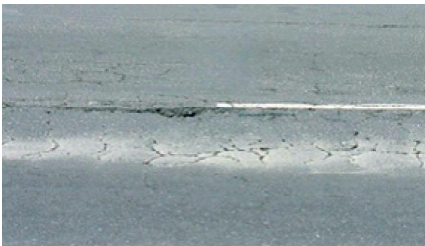
Figura 37 – Bombeamento de finos em pavimento asfáltico
