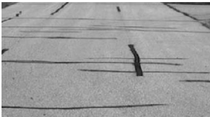
Figura 25 – Trincas leves relacionadas a movimentação térmica em pavimento asfáltico
