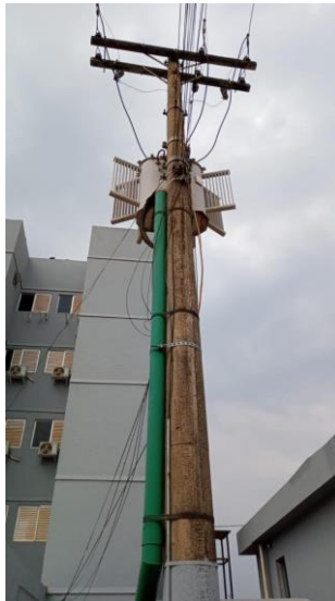
Figura 6 - Transformador da subestação 2.
