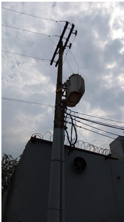
Figura 7 - Transformador da subestação 3.
