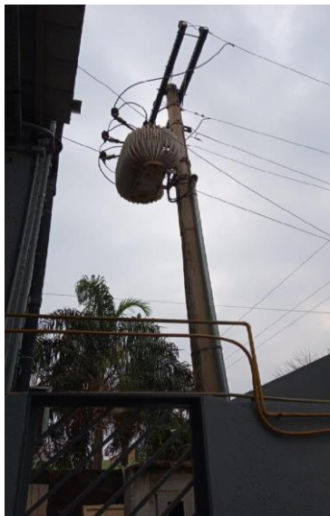
Figura 4 - Transformador da subestação 1.
