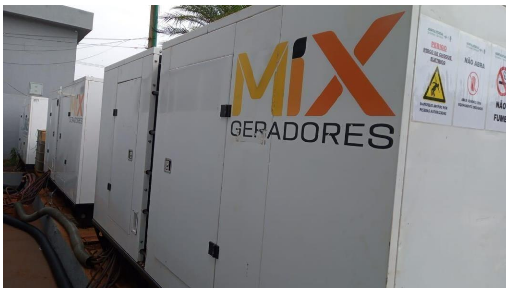
Figura 8 - Geradores do Hospital São Marcos
