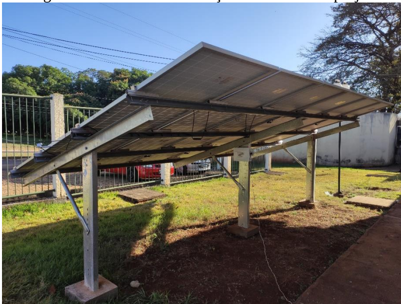
Figura 174 - Local de instalação do circuito do projeto
