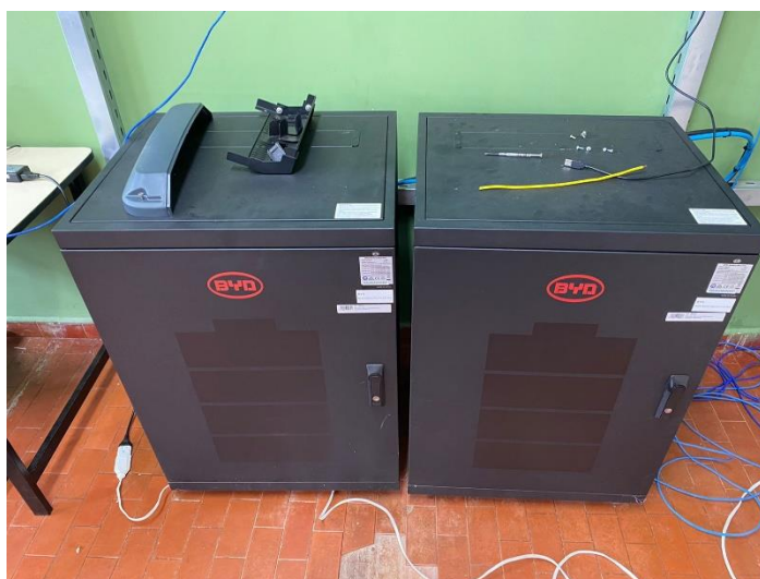
Figura 56 – Banco de baterias utilizado no sistema monitorado
