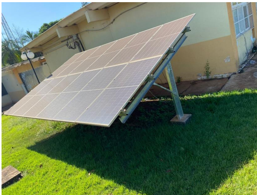
Figura 54 – Usina Fotovoltaica monitorada no presente trabalho
