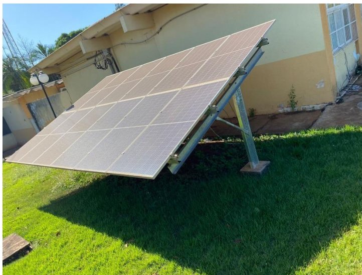
Figura 3 – Usina solar responsável por fornecer energia ao laboratório de Fontes Renováveis
