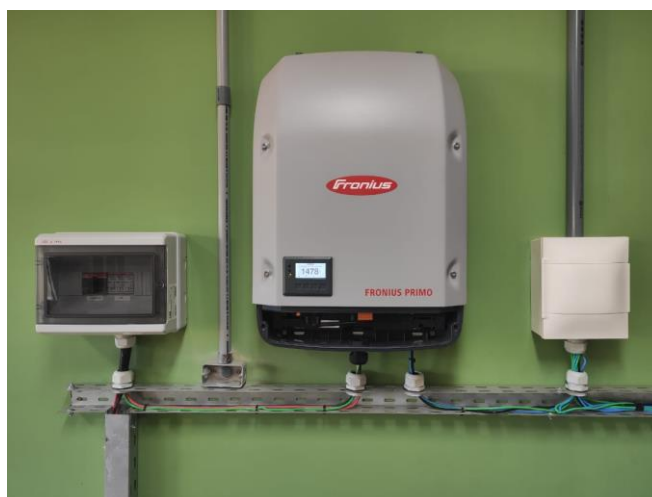
Figura 55 - Inversor utilizado na usina solar monitorada
