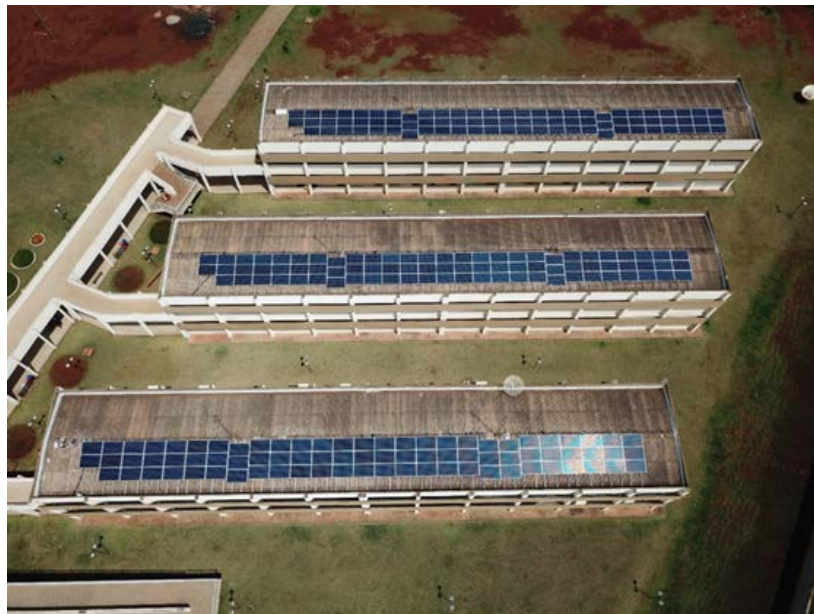
Figura 11 – Foto do SFCR instalado no IFG Campus Itumbiara (Acervo Pessoal)
