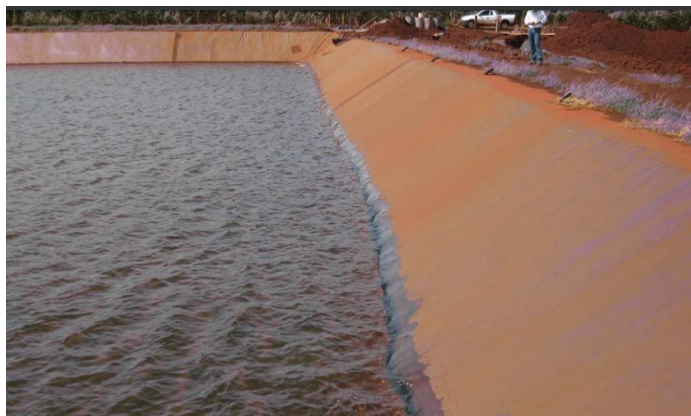
Figura 6: Tanque revestido com Vinilona.
